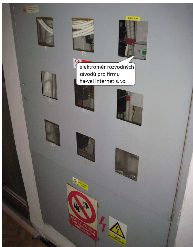
Obr. č.5, Umístění elektroměru rozvodných závodů ve 12.NP
