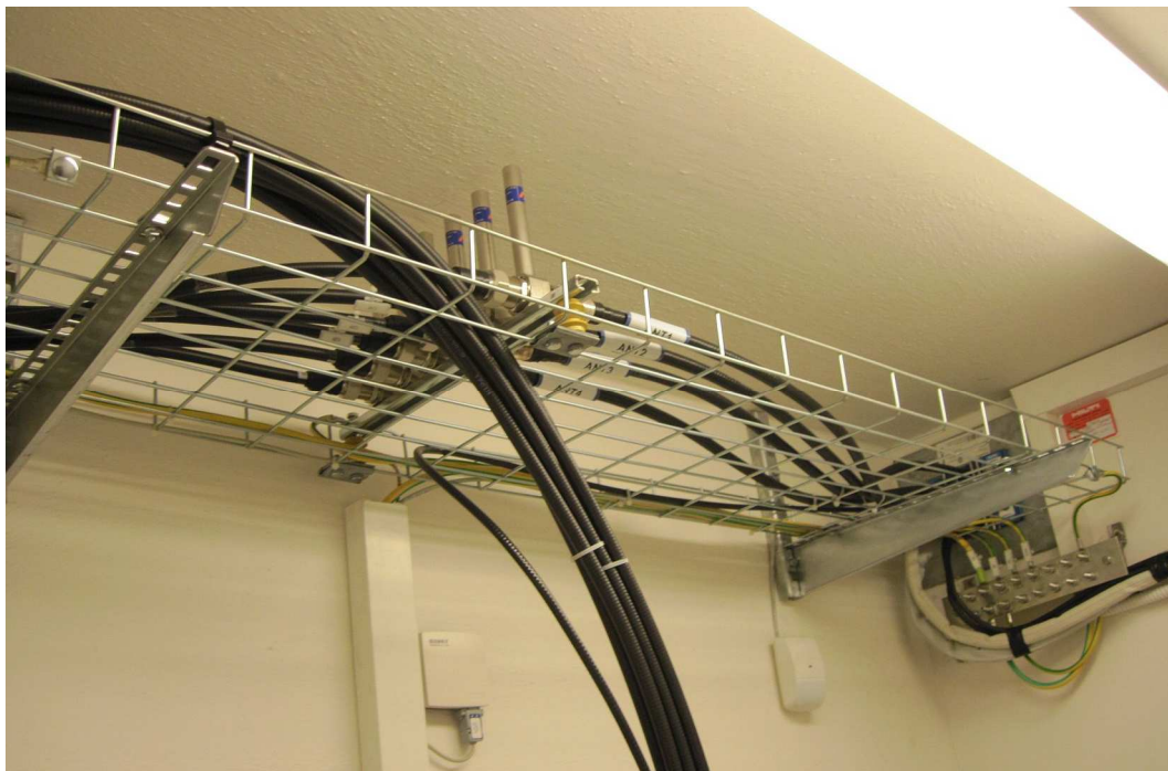
Obr. č.3, Kabelová trasa v místnosti datového rozvaděče (na obrázku ještě s kabely NT; nyní jsou kabely NT demontovány)
