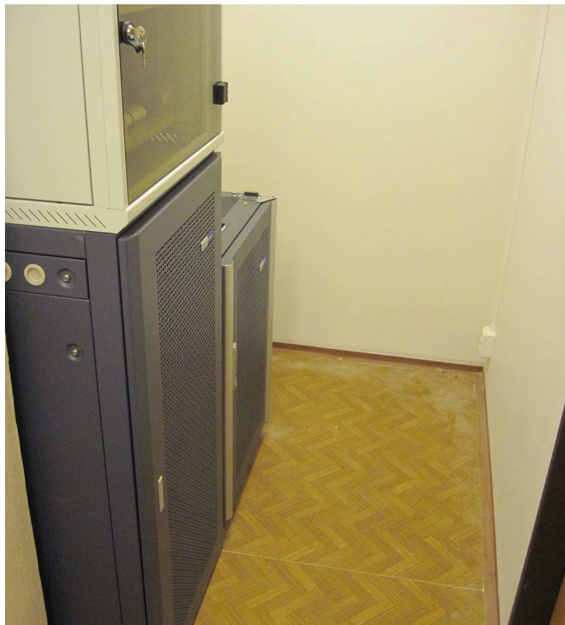
Obr. č.4, Místnost datového rozvaděče
