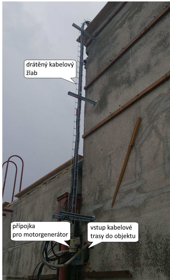
Obr. č.2, Kabelová trasa venkovní na boční stěně nástavby
