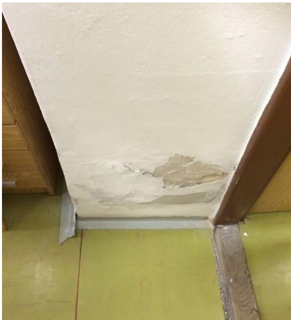
Projev vztlínající vlhkosti na obvodovém a středním zdivu
