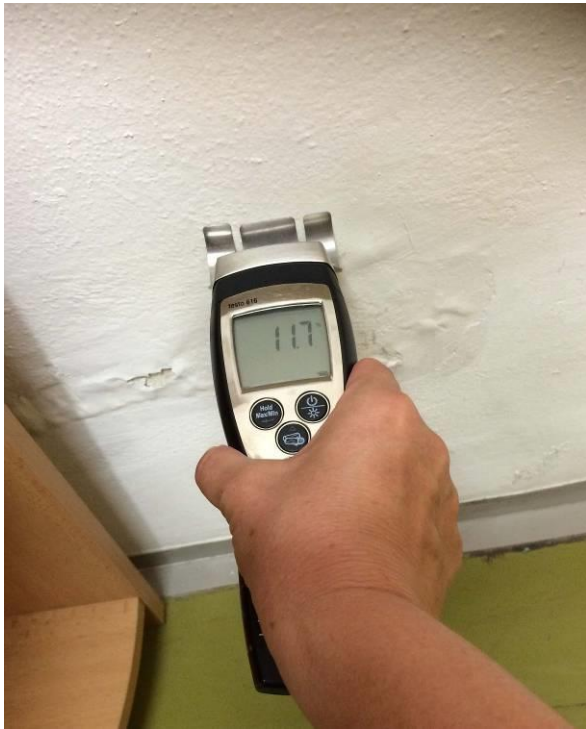
Degradace vnitřních omítek a orientační měření
