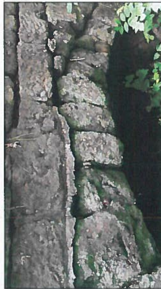
Rozvolnění čelní zidky a klenby na pravé straně konstrukce.
