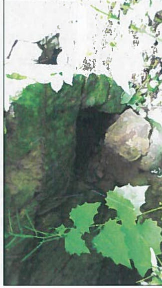
Rozpad opěry 2 na pravé straně
