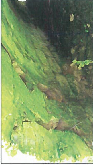
Trhliny v klenbě procházející až do opěr
