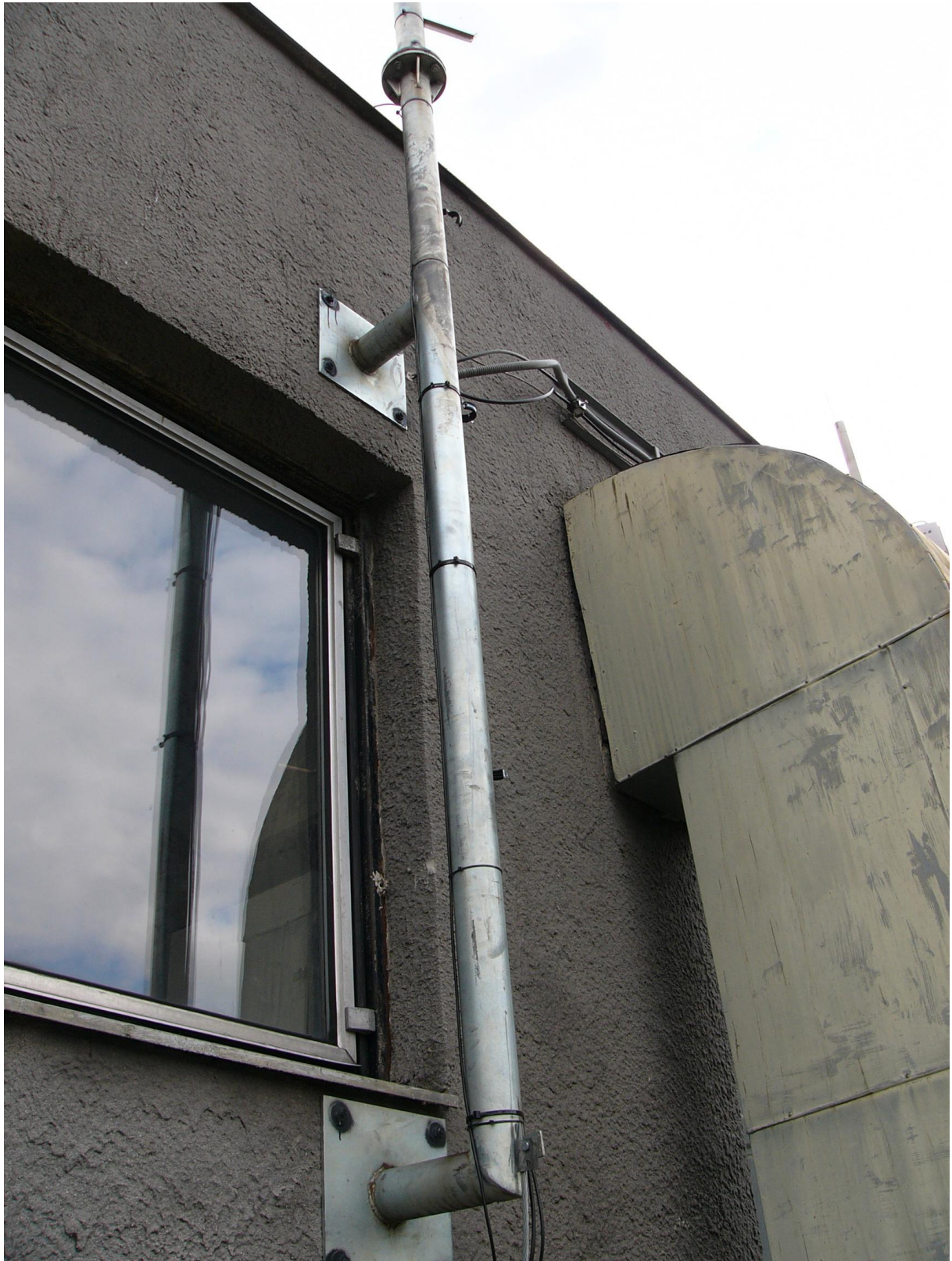
Kotvení stožáru společnosti Internet Expert s.r.o. na severní straně tubusu schodiště (části budovy D1c)
