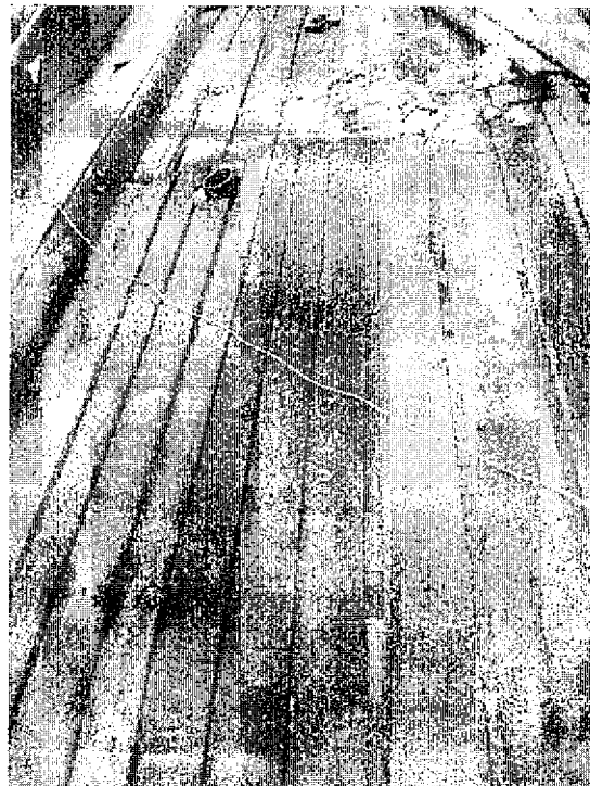
Foto č. 14 – ztrouchnivělý a rozmočený prkenný záklop v horní části střechy
