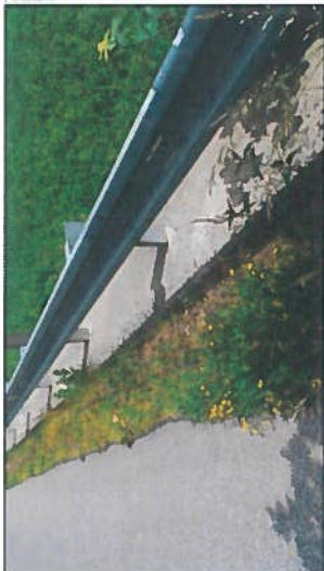
Uchycená vegetace na nadražení vozovky a římsy na pravé straně
