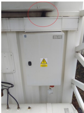
Obrázek č. 2 Nevhodné umístění přívodního kabelu
