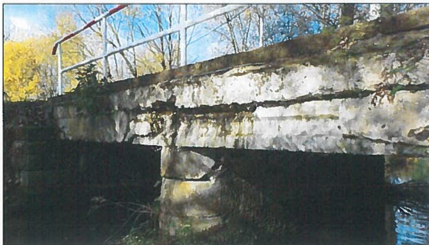
Degradace betonu římsy, uchycená vegetace, trhliny na PI na pravé straně
