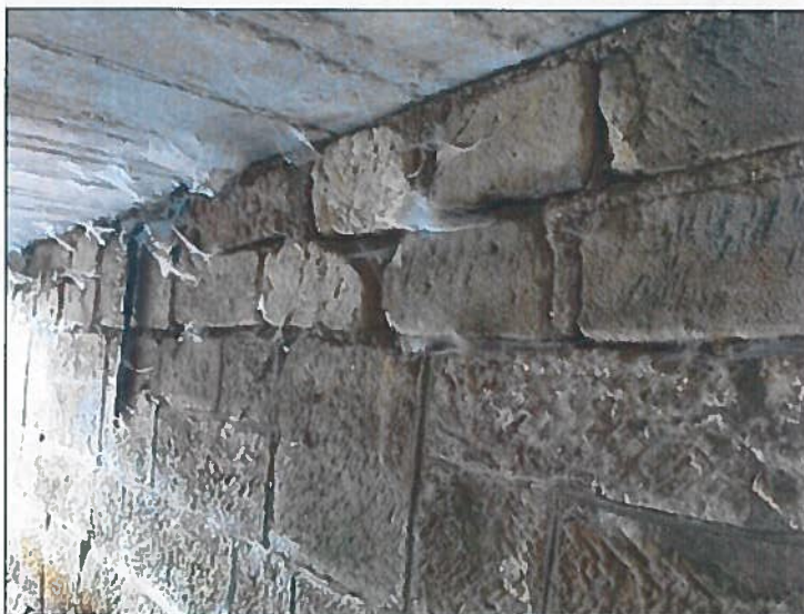
Rozvolnění OP1 pod uložením NK
