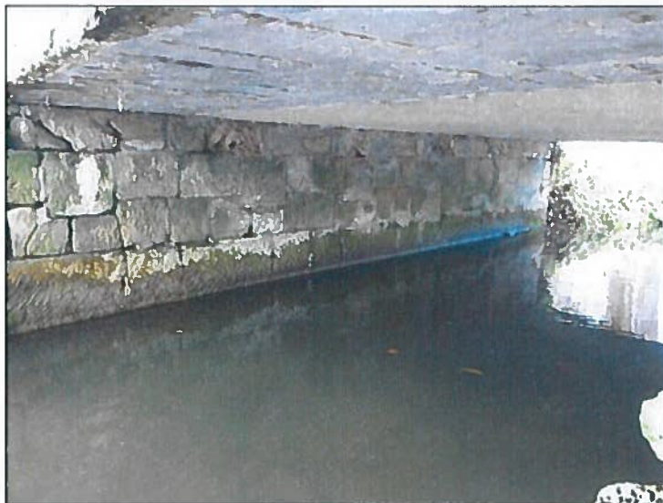
Pohled na OP3, trhliny a rozvolnění opěry
