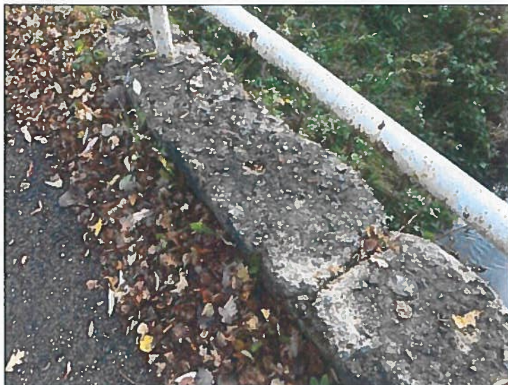
Degradace betonu římsy, koroze zábradlí
