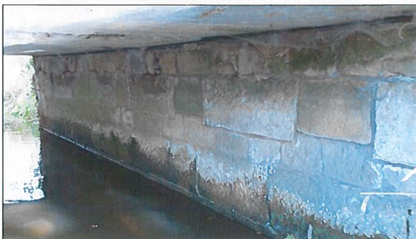
Pohled na PI2, lokálně vypadlé spárování, rozpad kamenů v místě uložení
