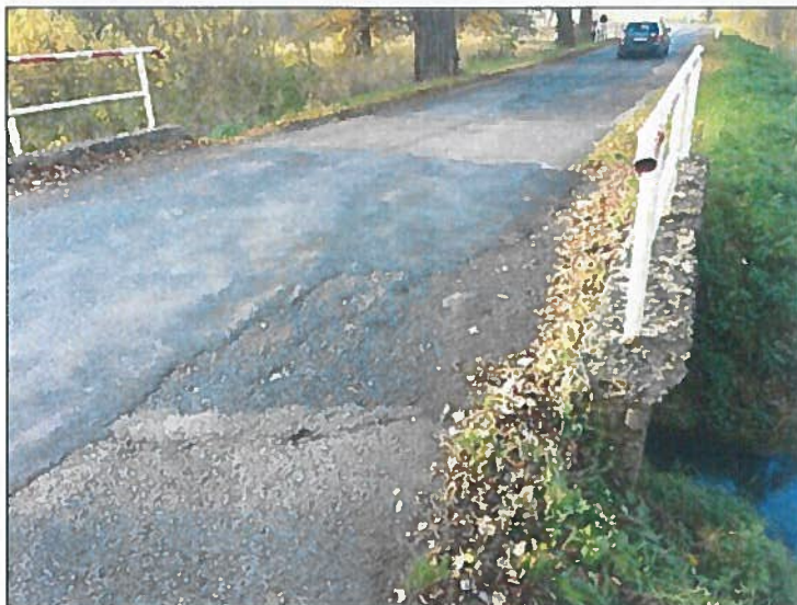
Trhliny ve vozovce
