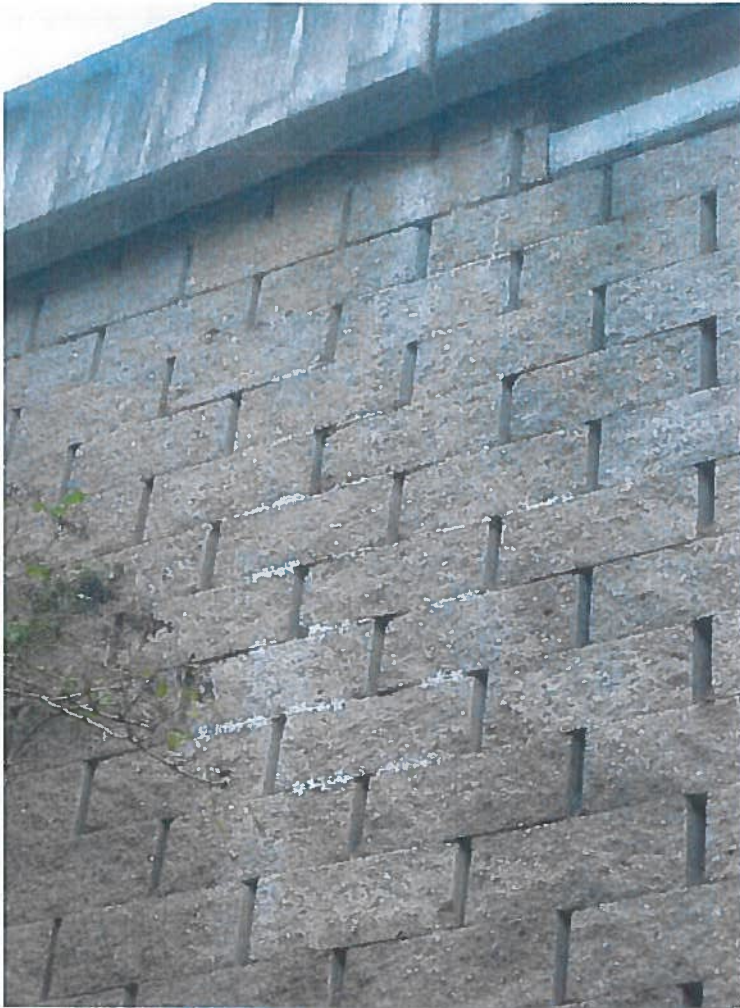
Dtto - zatékání a výluhy
