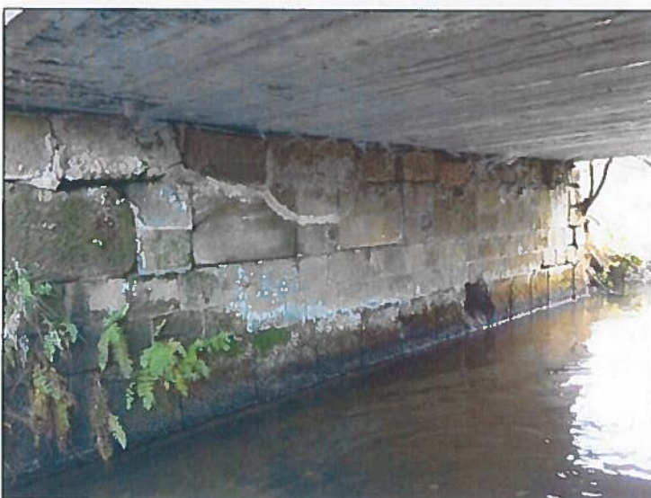
Pohled na OP2, trhliny, rozvolnění, chybějící spárování
