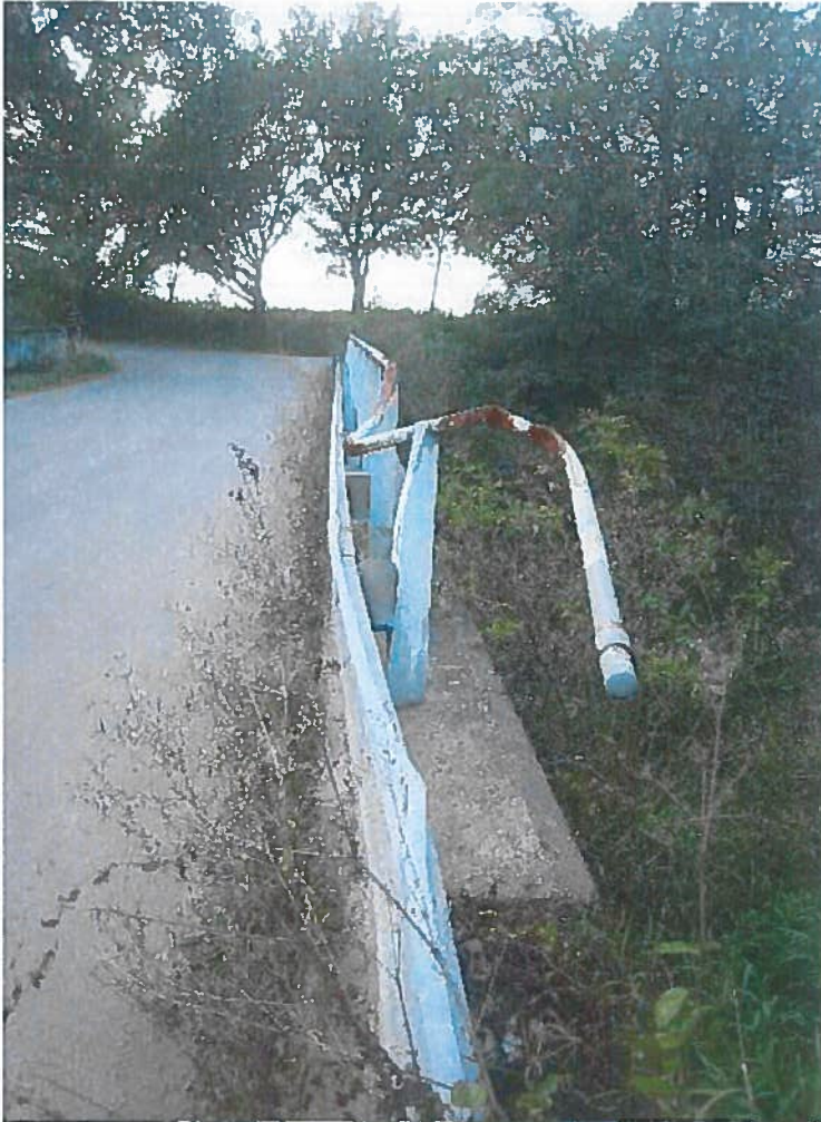
Stav zábradelního svodidla.
