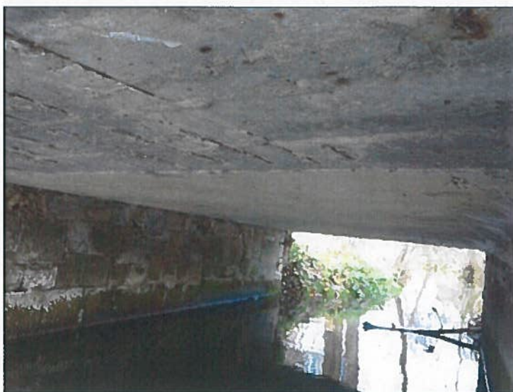
Pohled na OP1, lokálně vypadlé spárování
