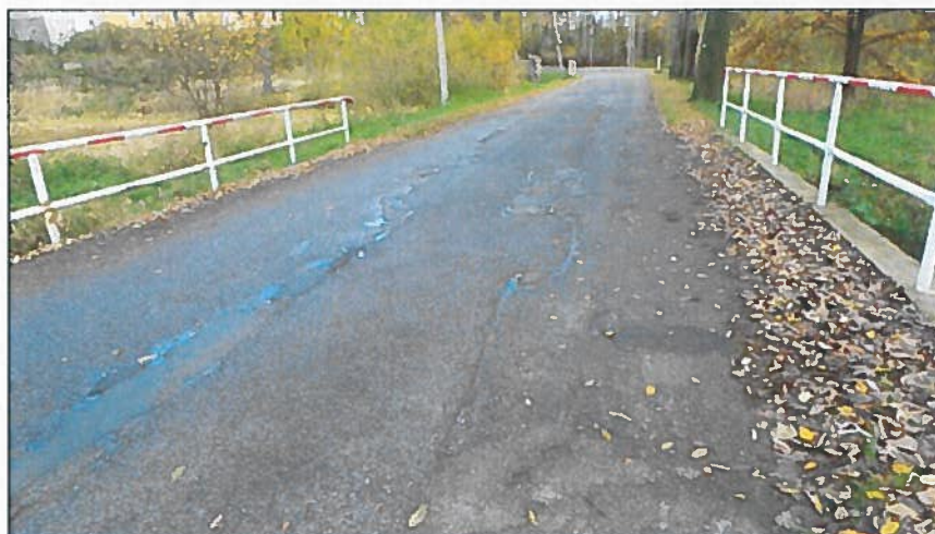
Trhliny ve vozovce
