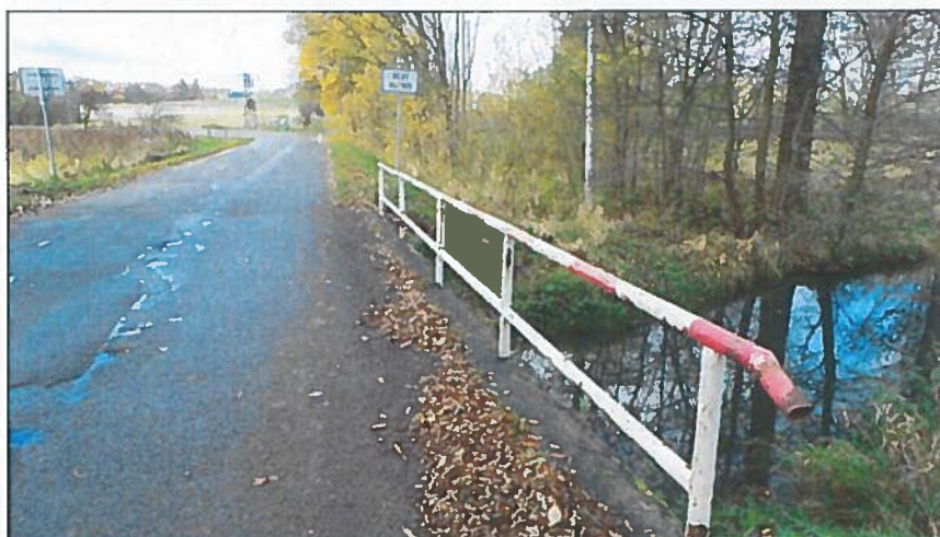
Degradace betonu římsy, nečistoty na kraji vozovky, lokální koroze zábradlí
