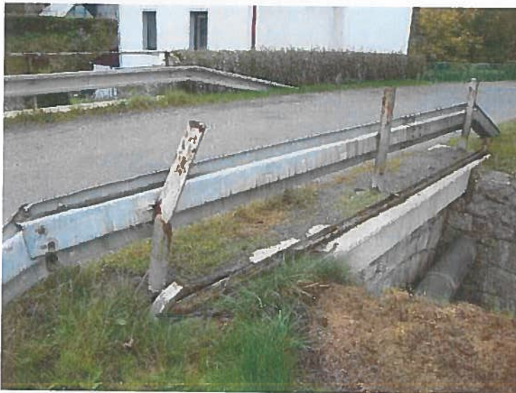
Poškozený zadržný systém
