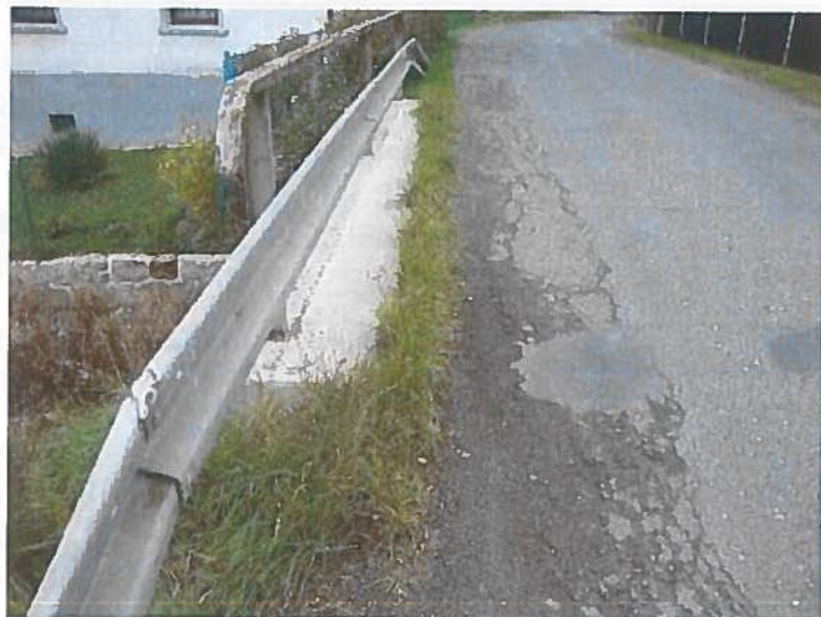
Znečištěná pravá krajnice a poruchy krytu komunikace
