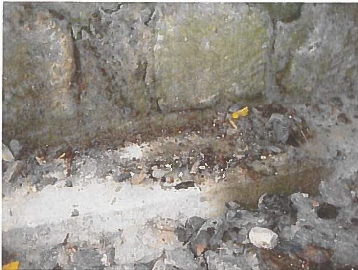
Vypadané spárování v OP1
