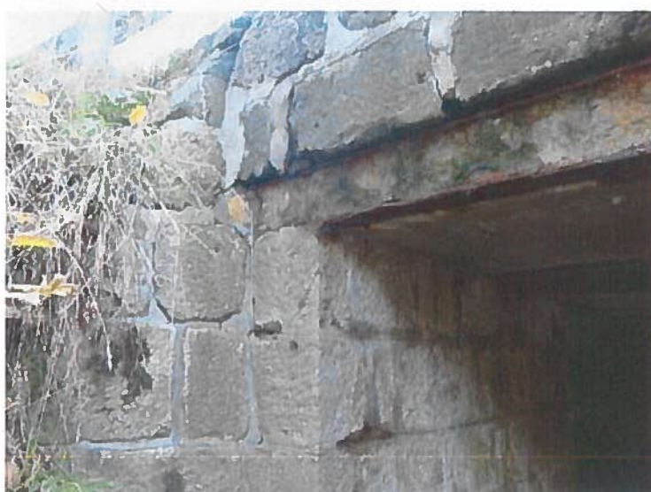
Zatékání a koroze krajního ocelového nosníku vlevo u OP1
