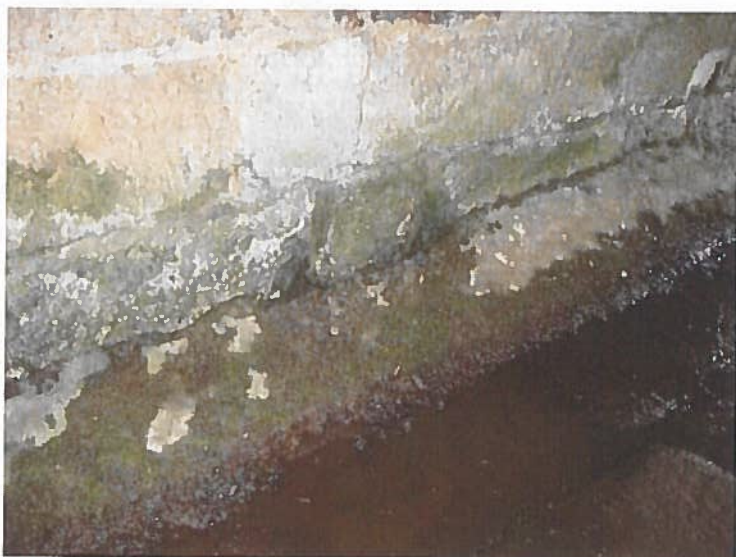
Degradující betonové klíny podél opěr
