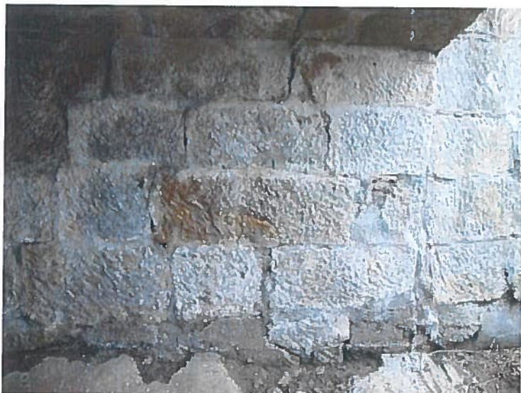
Zalomená trhlina v OP2 vpravo
