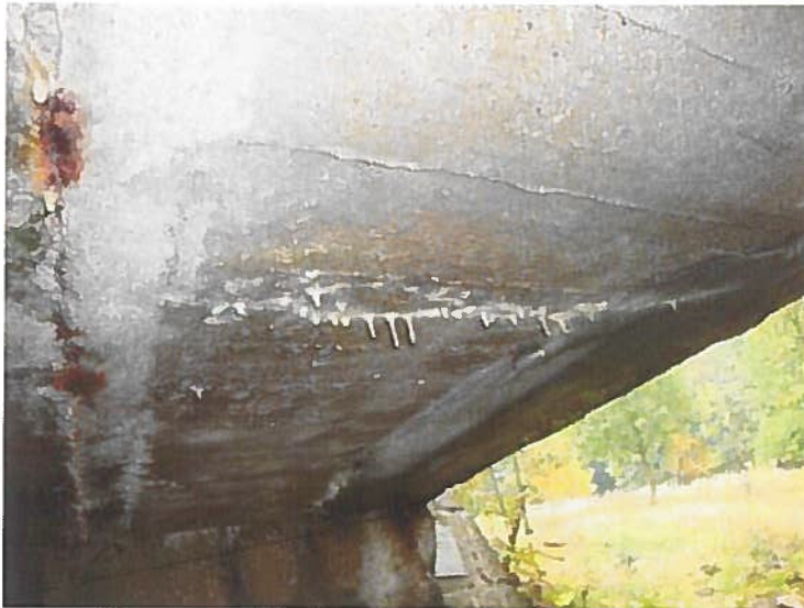
Zatékání mezi 1. a 2. ocelovým nosíkem vpravo
