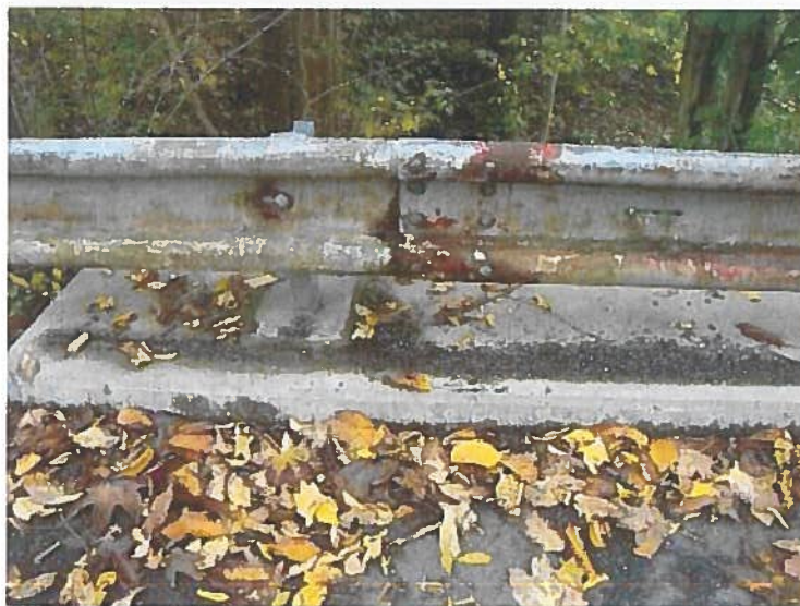
Koroze svodnic na levé straně mostu
