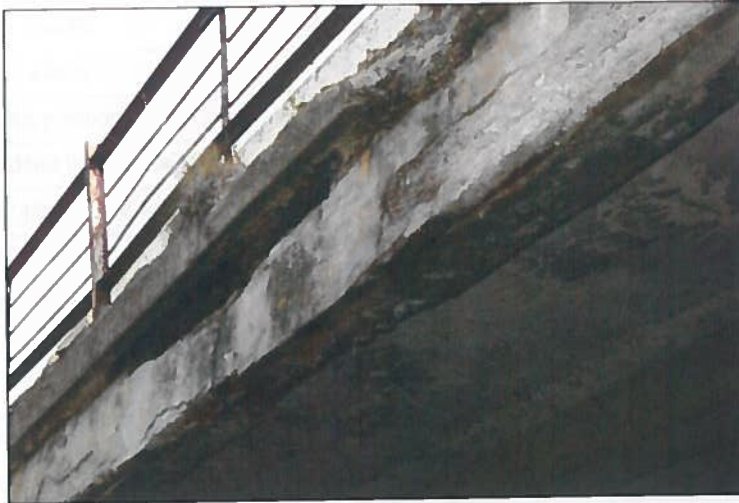
Rozpad římsy a NK v čele
