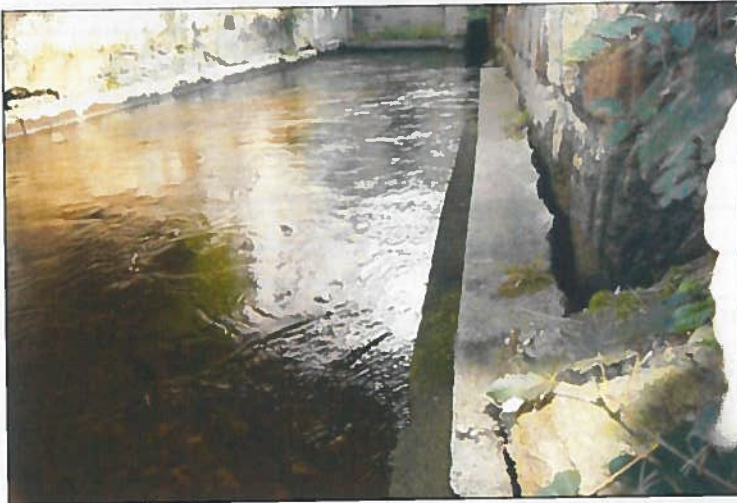
Stav betonového ochranného prahu na levobřežní opěře
