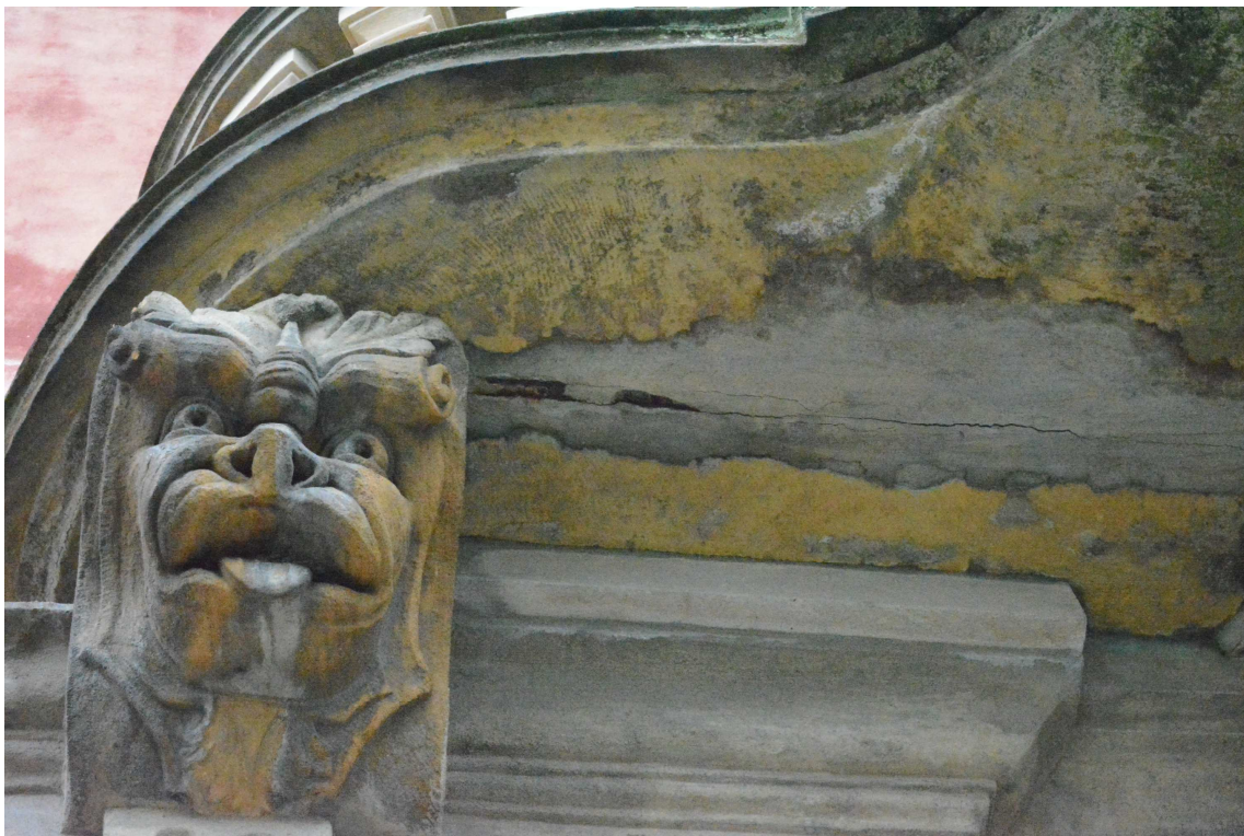
Detail poruchy vlevo nosné konstrukce (konzoly)
