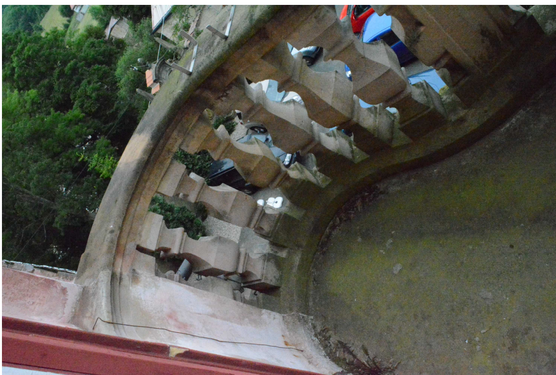
Pohled na zanedbaný a zdevastovaný povrch balkónové desky (zanedbaná údržba a povětrnostní vlivy)
