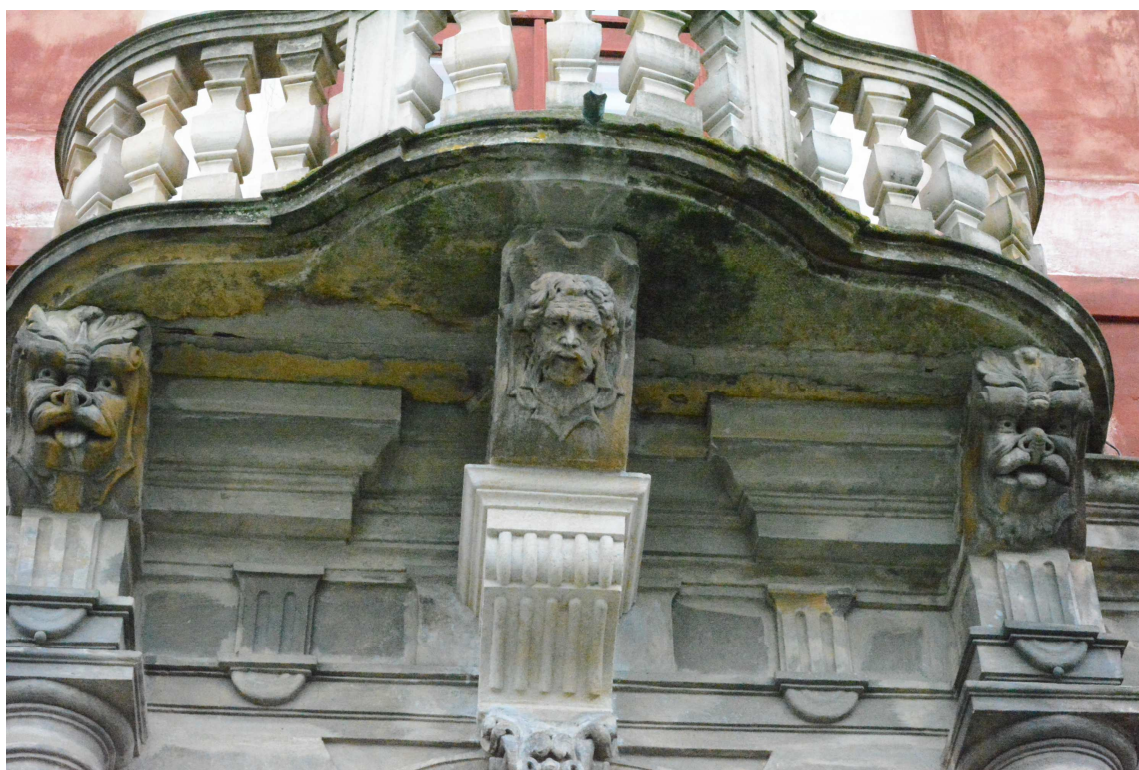
Spodní pohled na konstrukci balkónu – znatelný rozsah poruch v ploše
