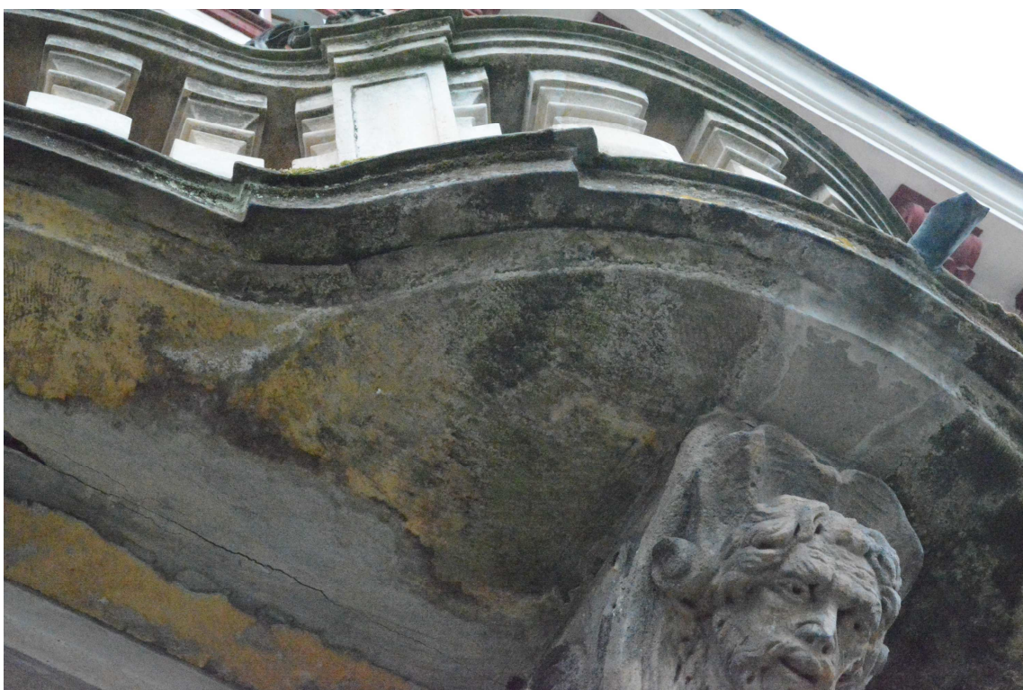
Detail poruchy vpravo nosné konstrukce (konzoly)
