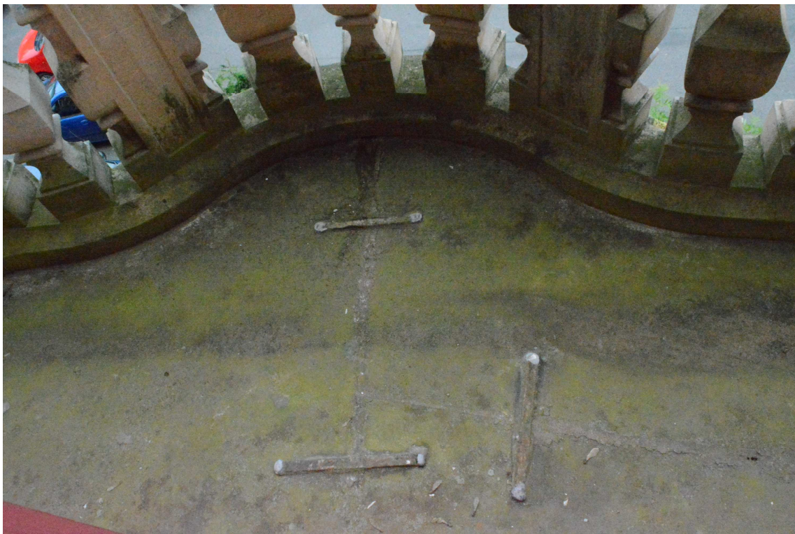
Staré „kramle“ zajišťující trhliny v horní ploše balkónové desky – jsou uvolněné a neplní řádně zamýšlenou funkci
