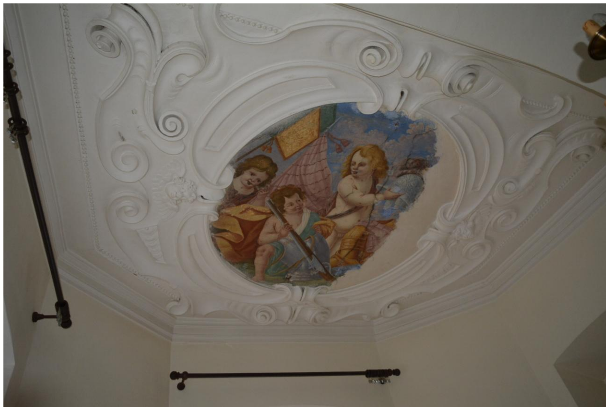
Celkový pohled na místo porušeného podhledu
