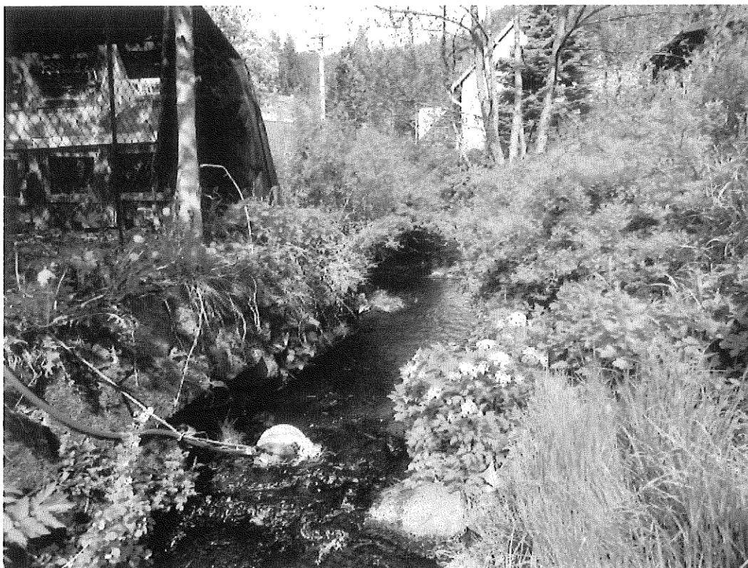
Obrázek 1: Stav kamenných dlažeb v ř.km 4,300
