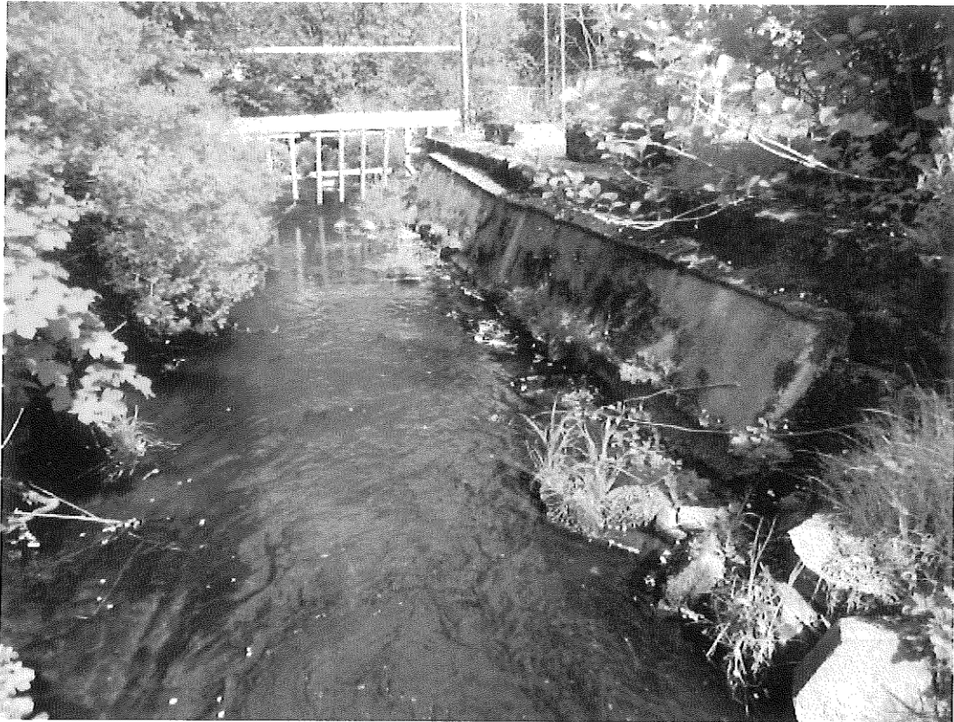
Obrázek 3: Ř.km 4,350 - na PB rozpadající se betonová zeď, na LB kaverna (chybějící dlažba), dno vymleté (taktéž chybějící dlažba)
