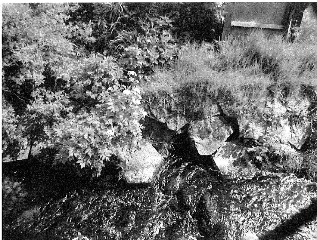
Obrázek 2: Stav dlažeb na PB v ř.km 4,300
