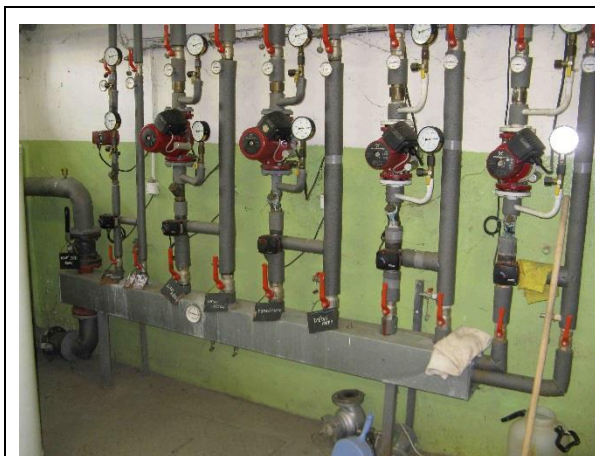
Čerpadlové skupiny, trojcestné ventily se servomotory, sdružený rozdělovač a sběrač topné vody a kontrolní přístroje v plynové kotelně
