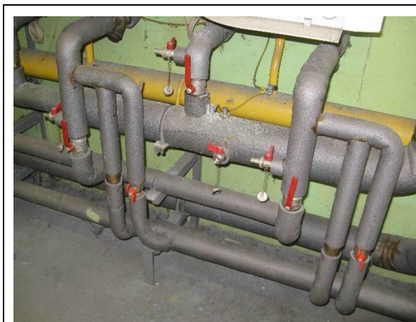
Potrubní systémy plynové kotelny a přívodní potrubí ZP
