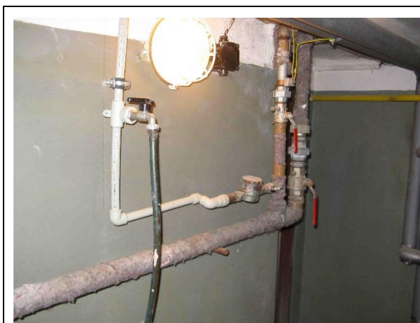
Potrubní systémy s izolací a vodoměr
