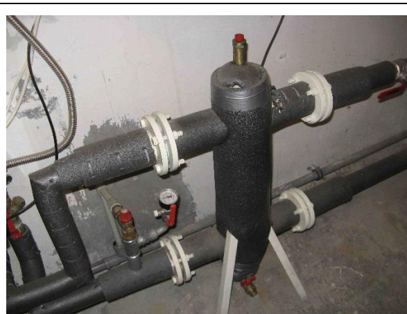
Hydraulický vyrovnávač dynamických tlaků HVDT II a část potrubních systémů plynové kotelny
