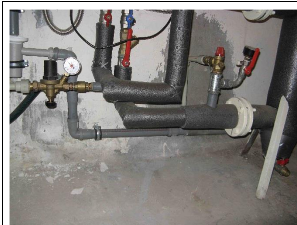
Potrubní systémy s izolací, armatury a pojišťovací ventil
