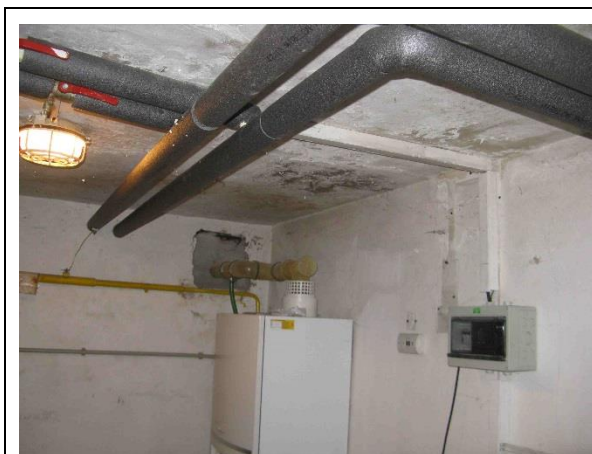
Potrubní systémy v plynové kotelně
