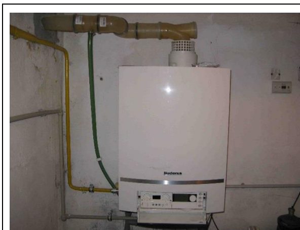
Nástěnný kondenzační plynový kotel Logamax Plus GB 162-45
