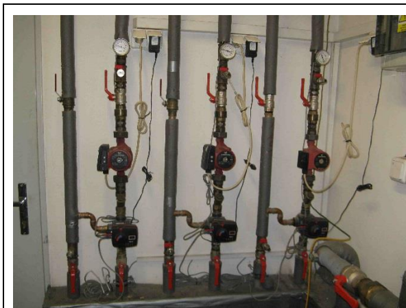
Oběhová čerpadla, regulační ventily se servomotory a kontrolní prvky MaR plynové kotelny
