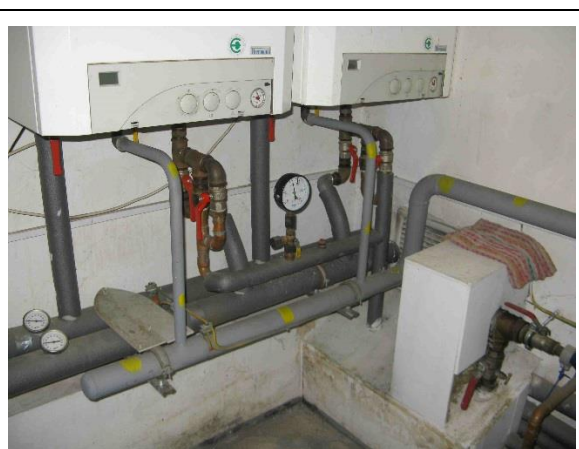
Potrubi systémů pod plynovými kotle
