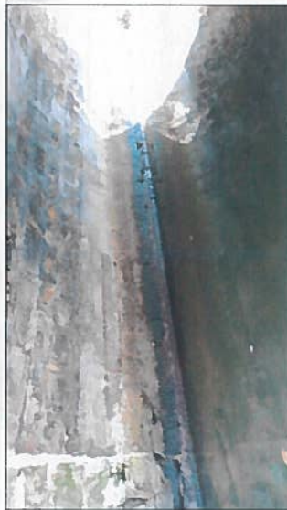
Pohled na OP1, drobné kaverny v úrovni hladiny
