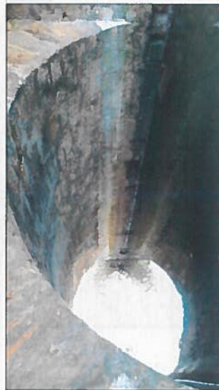
Pohled na OP2, výrazné kaverny v úrovni hladiny, opěra je patrně podzemní
