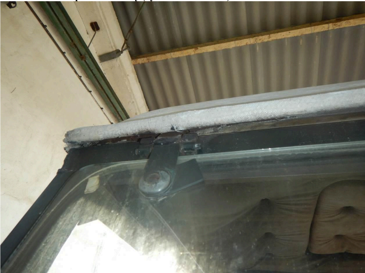
Foto č.9 – vadné upevnění střechy (vytržené z laminátu)
