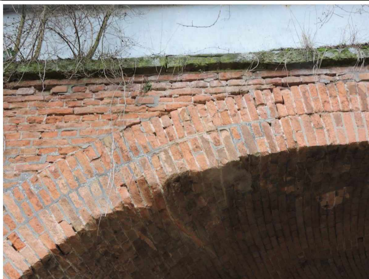
Foto č. 1 Konstrukce K 01 – čelní zedř vlevo – průsak vody
