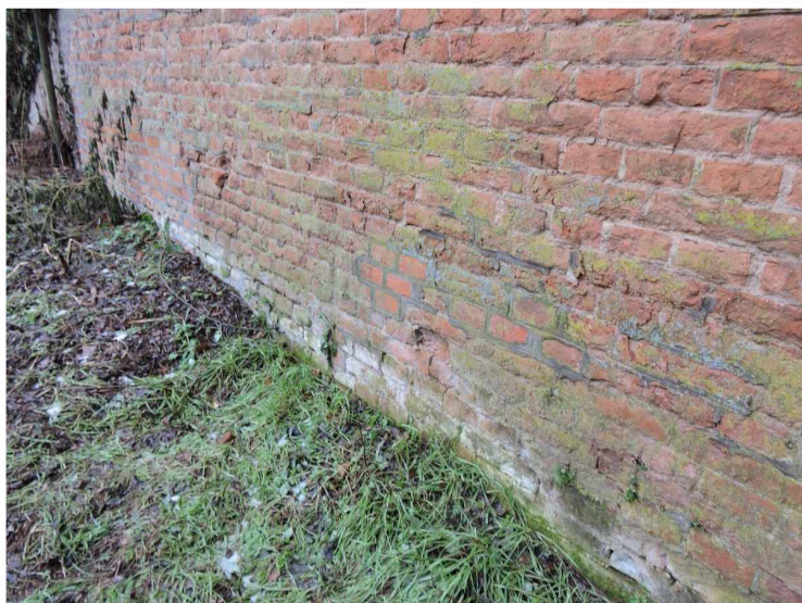
Foto č. 5 Opěra O 02 – křídlo vlevo – průsak vody
