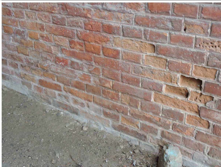
Foto č. 4 Opěra O 02 – průsak vody
