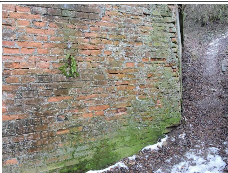
Foto č. 3 Opěra O 01 – křídlo vlevo – průsak vody
