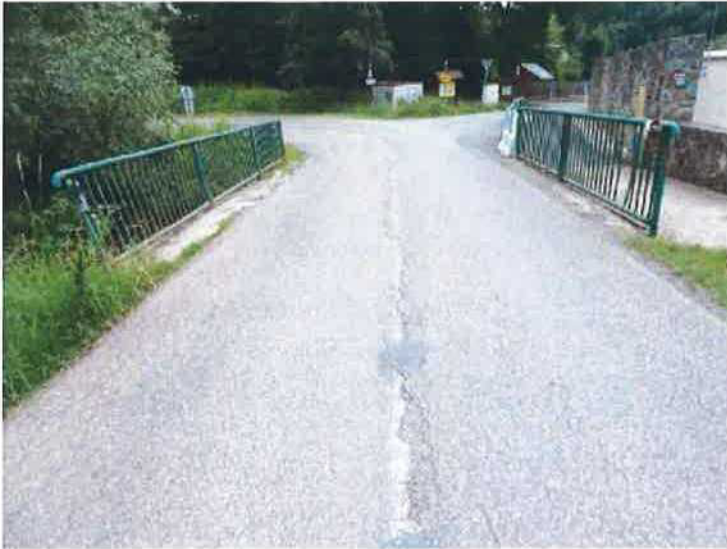
Pohled na mostní svršek ve směru staničení, otevřená podélná spára v ose vozovky, deformované zábradlí.
