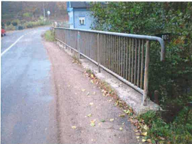
Degradace betonu říms
