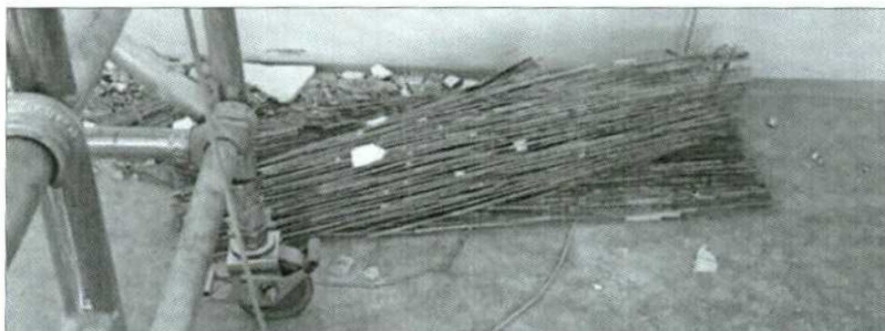
Spadlý rákos s mítkou stropu.
