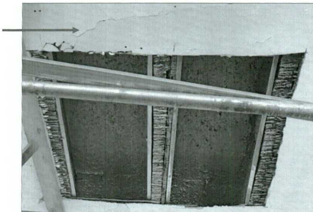
Rozsah spadlé omítky stropu.
