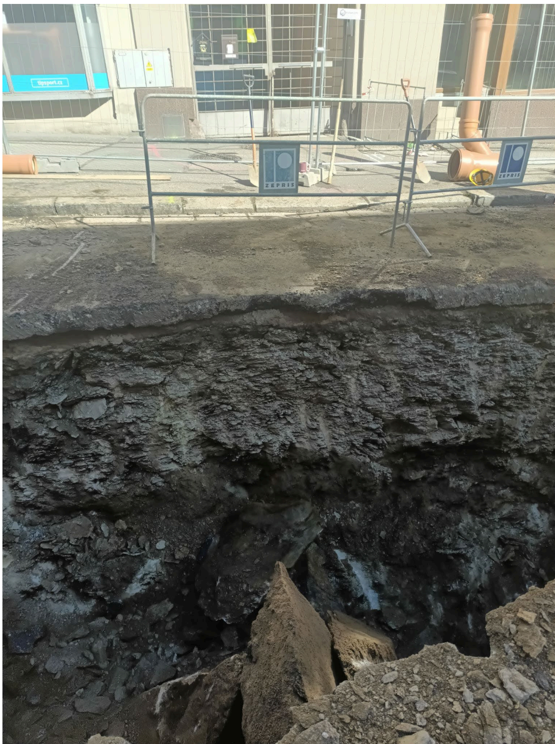
Obrázek 7. Mezi ŠK2 a ŠK3, 5 m od ŠK2, hloubka 2,7 m, u vchodu do domu č.p. 47.
