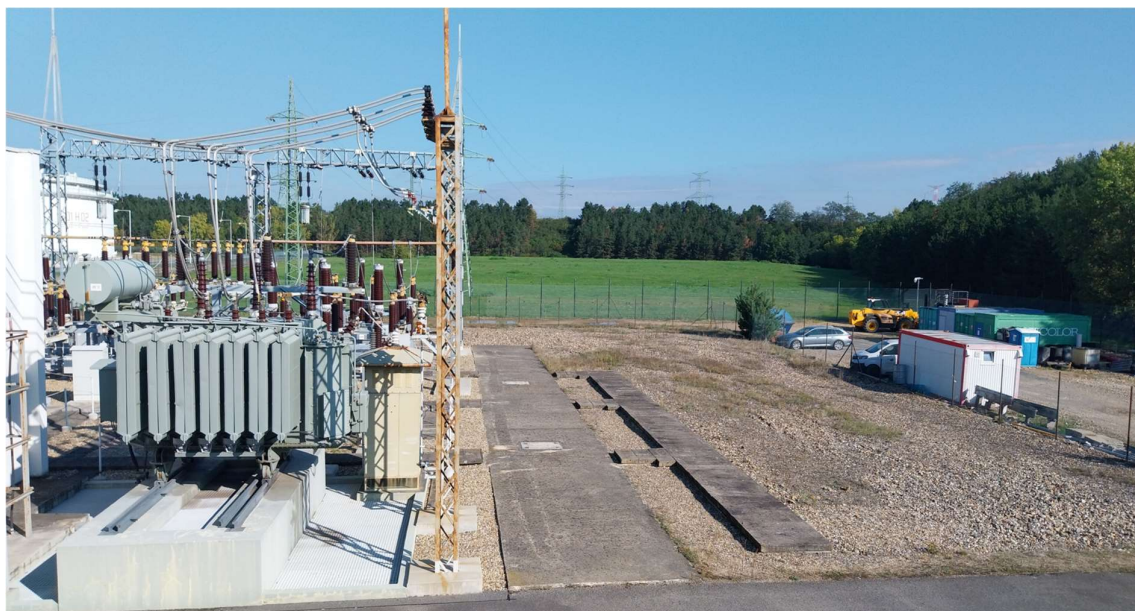
Obrázek 3: Pohled na využitelnou plochu za stávající hlavní elektro rozvodnou areálu
