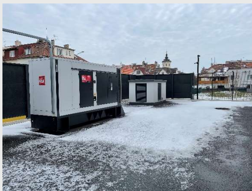
11: Diesel a trafo u SOLID21
