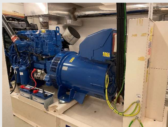
15: Diesel generátor v budově A
