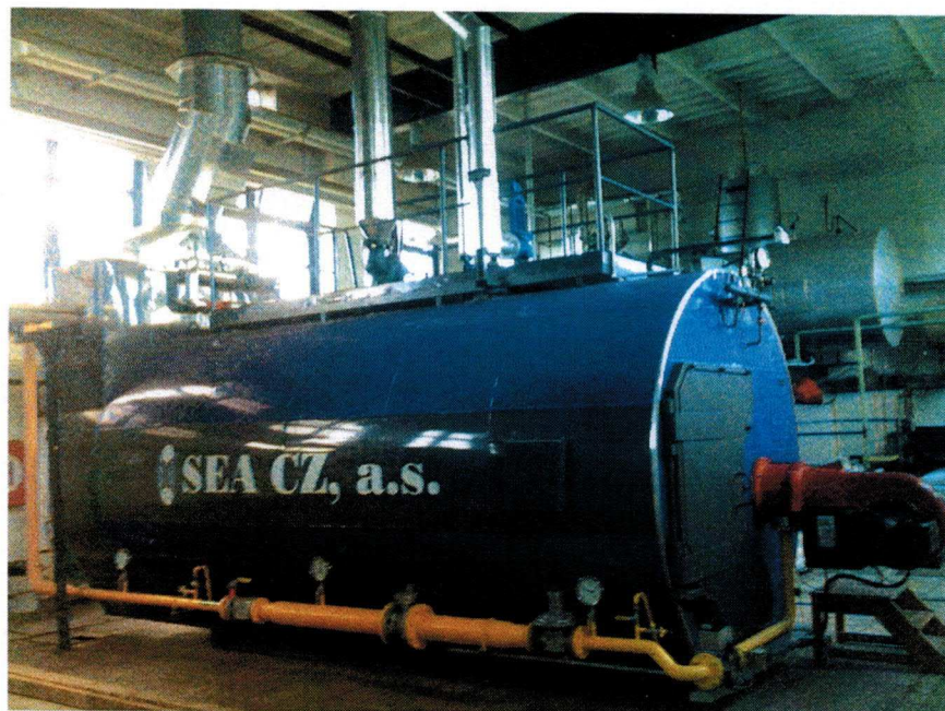
Kotel SBK 6 po instalaci u zákazníka
