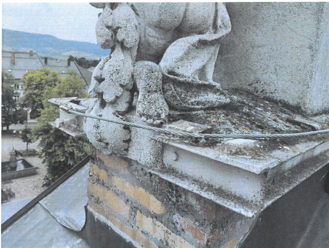
Obrázek 5: Detail stažení centrálního sousoší a nevhodné uchycení ocelového lana.
