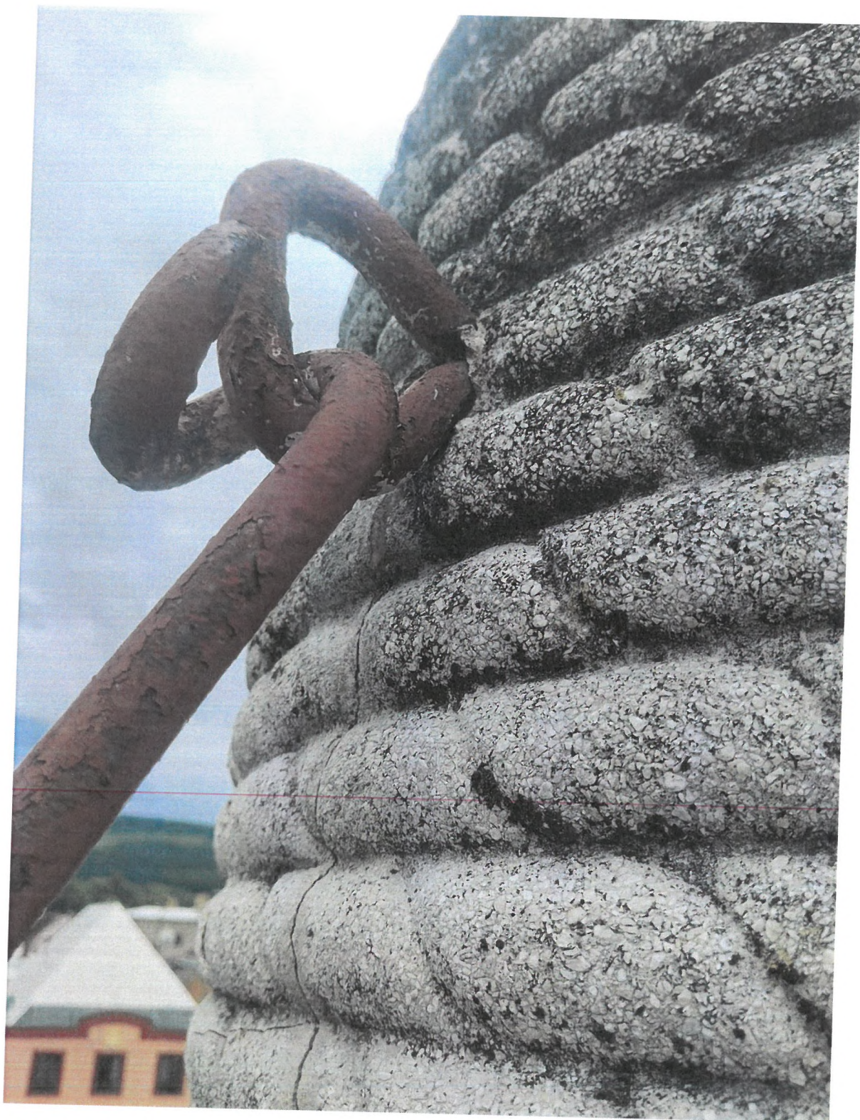
Obrázek 7: Detail ukotvení centrálního susoší s viditelnými trhlinami.
