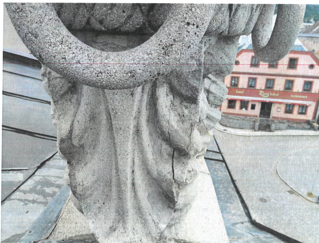
Obrázek 9: Detail rohu hojnosti s trhlinami a ztrátou originální hmoty.
