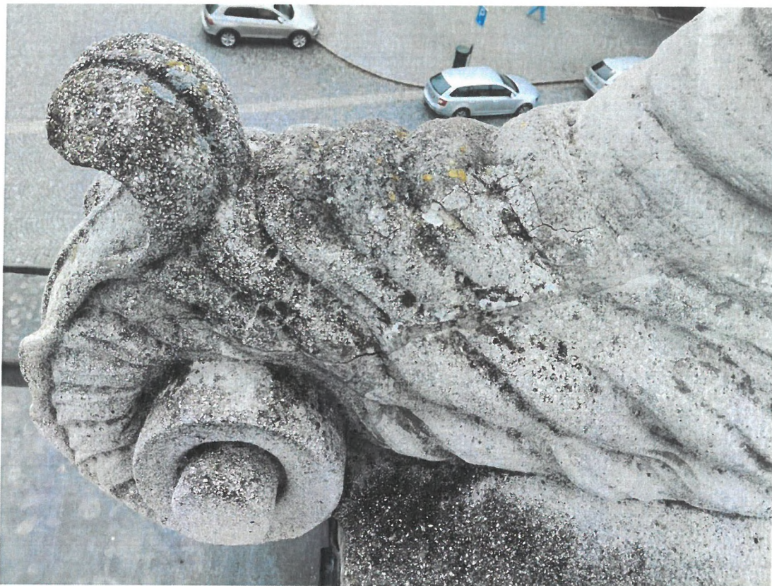
Obrázek 8: Detail rohu hojnosti s mikro trhlinami na povrchu.
