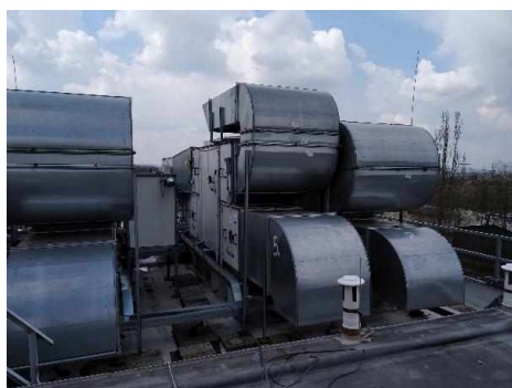
VZT jednotky umístěné na střeše objektu chirurgie
