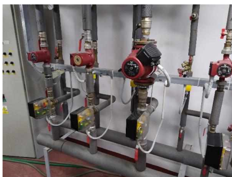
rozdělovač otopné vody ve strojovně VZT (6.NP)
