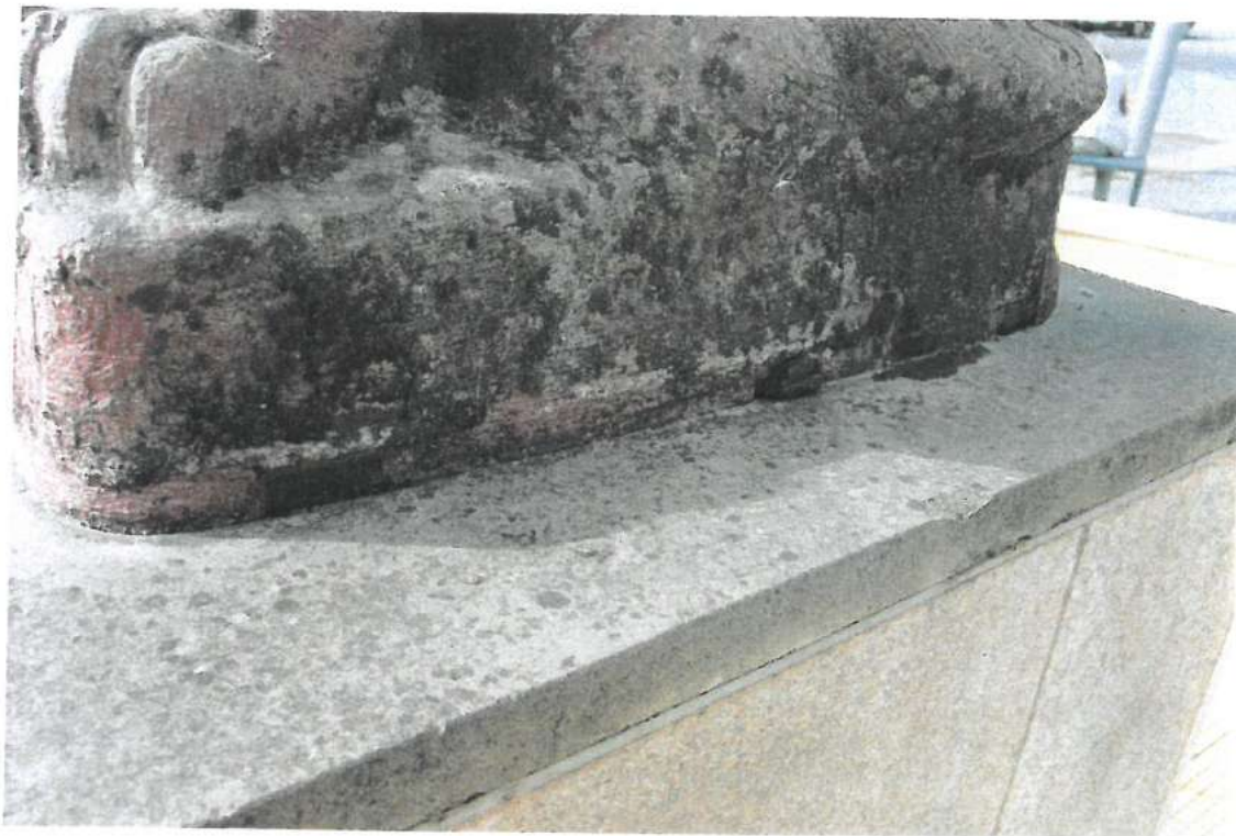
Dřevěné čepy ve spáře mezi soklovou architekturou a sousoším fontány.
