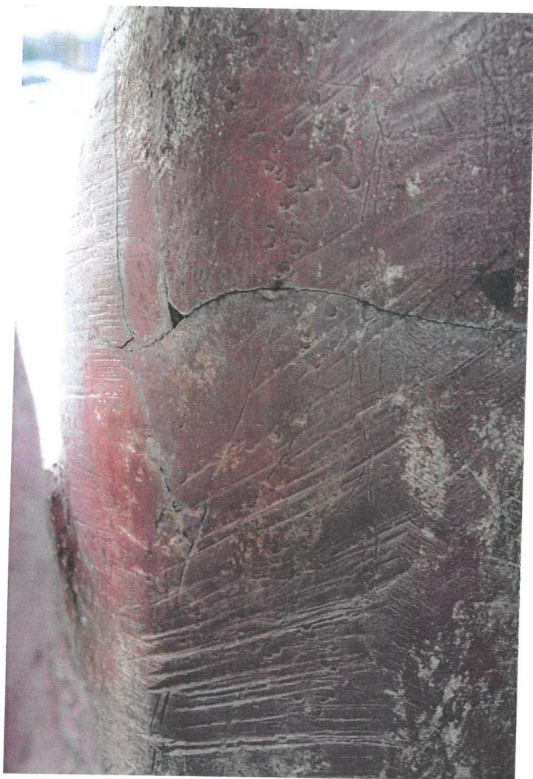
Trhliny ve sousoší procházející celou hmotou terakotového střeptu.
