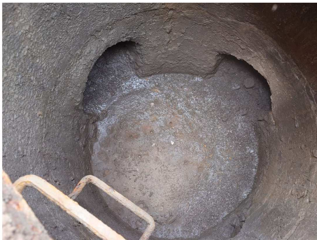
Foto č.2 – zanesené potrubí v šachtě
