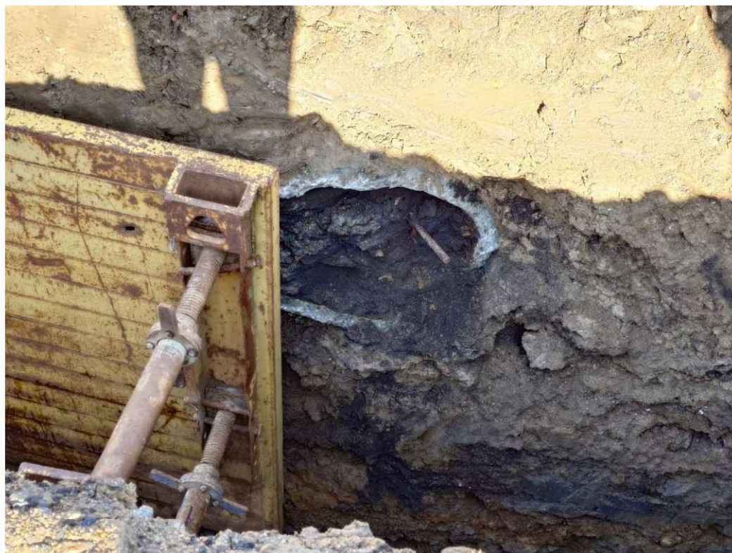
Foto č.3 – zanesené potrubí do šachty
