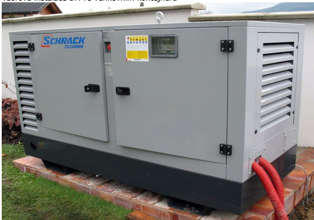
Vzorová instalace DA ve venkovním kontejneru
