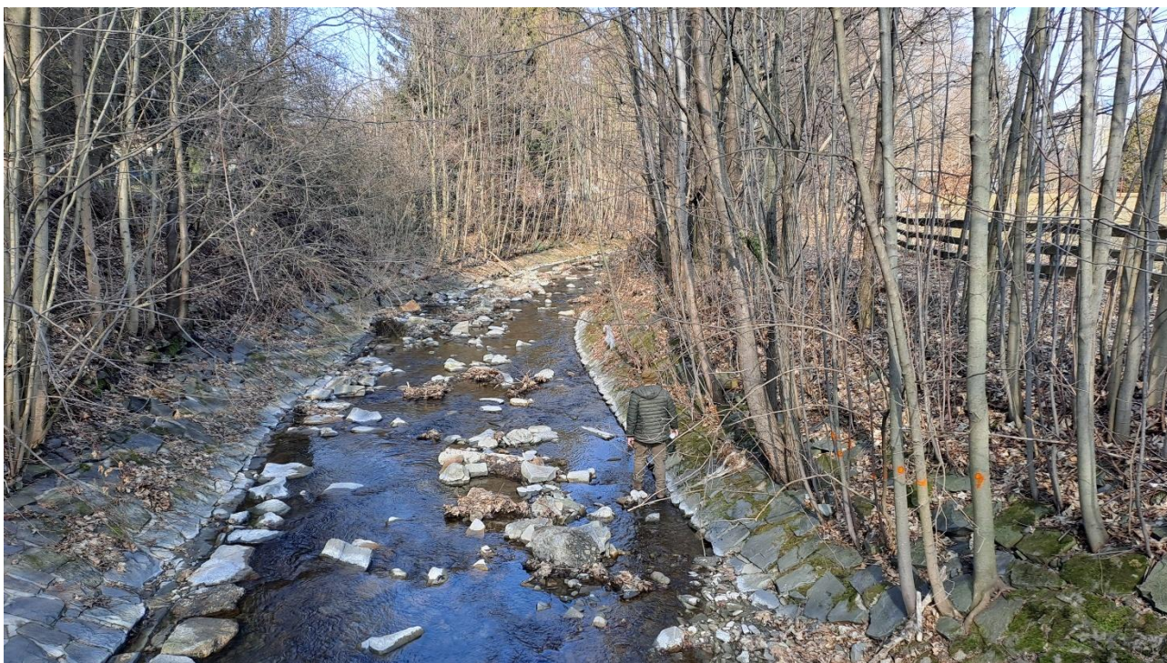
Nálety v opevnění koryta v ř. km cca 0,550
