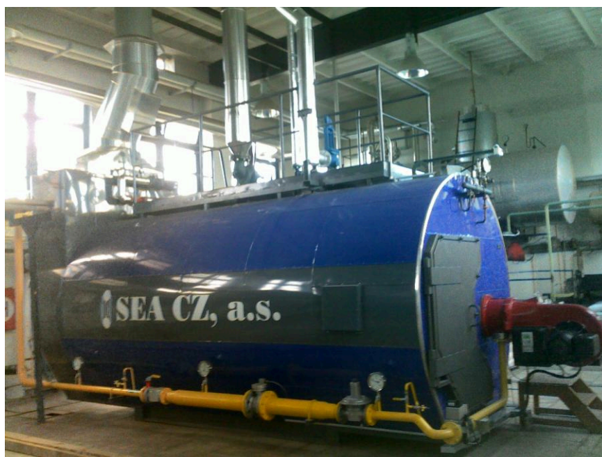
Kotel SBK 6 po instalaci u zákazníka
