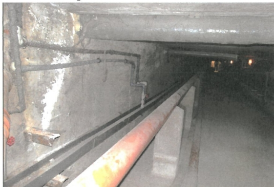
Vodovodní potrubí v kolektoru
