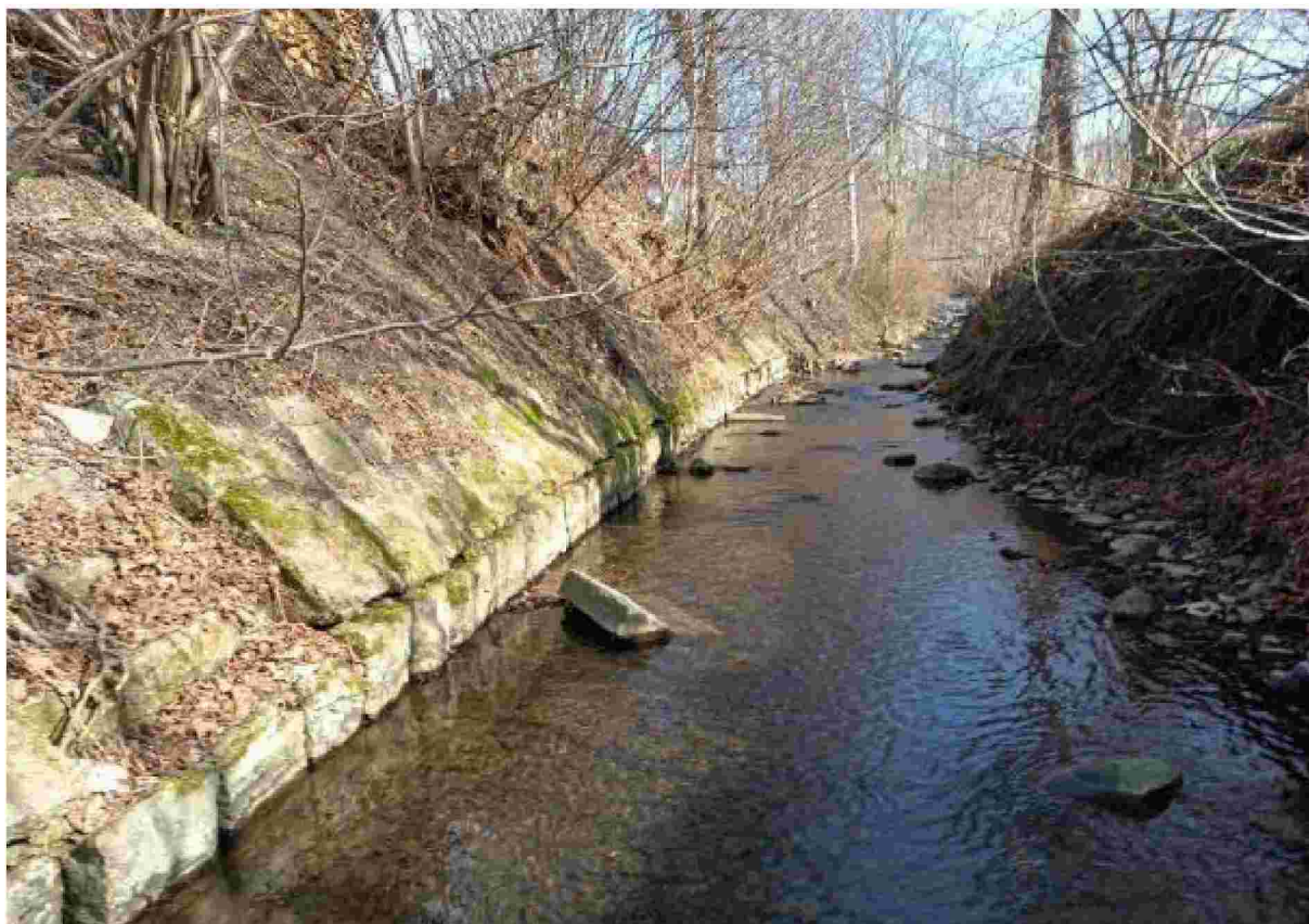
Podélné PB opevnění dlažbou – obnažená patka v ř.km cca 1,180 + eroze svahu LB
