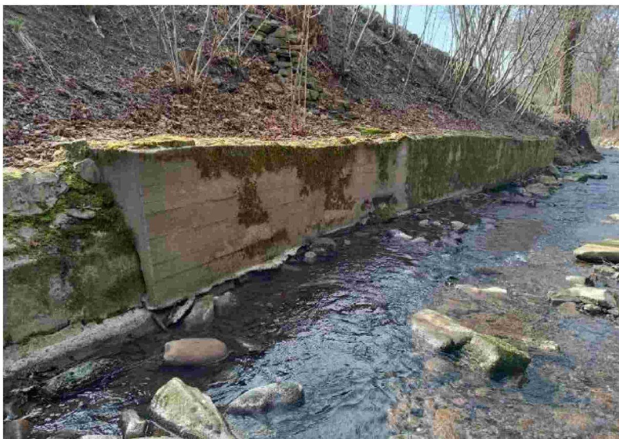
Podemletá LB betonová zeď ř.km 1,250 – pohled po toku
