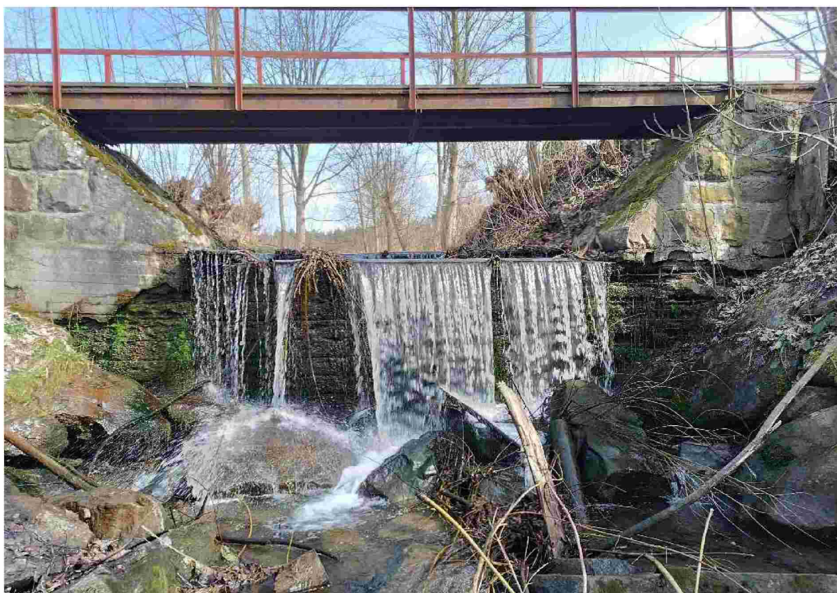
Stupeň ř.km 1,391 (silně narušena konstrukce pod křídly) – pohled proti toku
