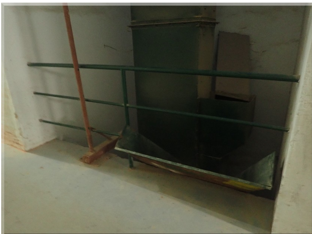
Foto PB266072: 02-f - sklad šišek - zábradlí šachty elevátoru (cca 5 pater)
