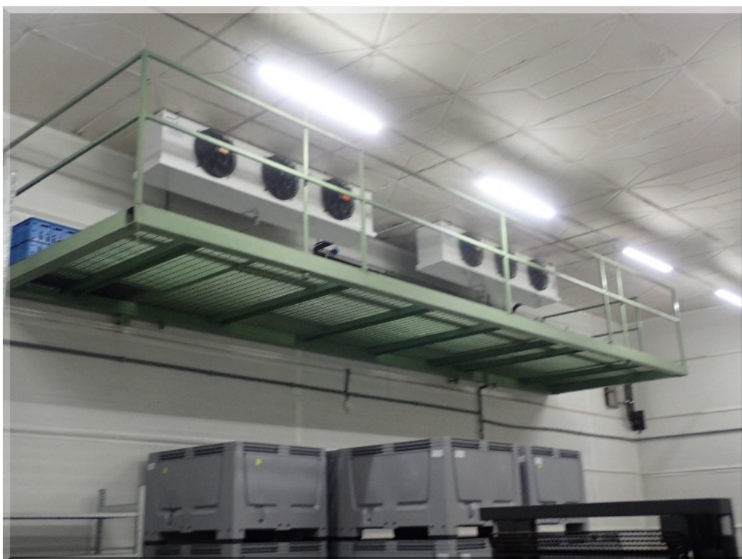
Foto PB266160: 06-b - mrazírenská hala - plošina v chladícím boxu č. 5 (plošina a zábradlí)
