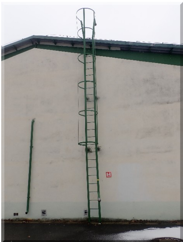
Foto PB266154: 06-g - mraziřenská hala - požární žebříky na střechu (2 kusy)
