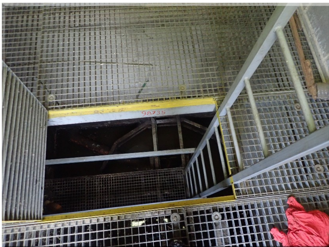
Foto PB266035: 09-b - ostatní stavby - čistírna odpadních vod (dvě patra plošin a žebřík)
