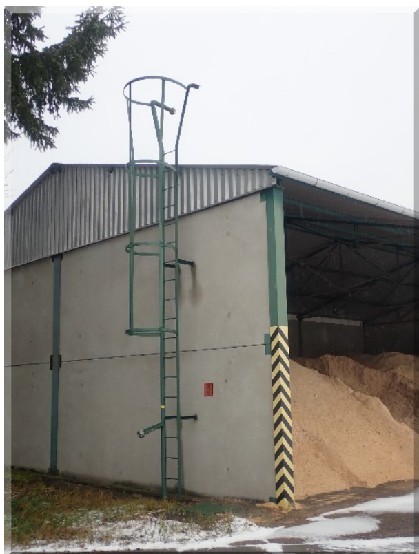
Foto PB266152: 09-m - ostatní stavby - požární žebřík na střechu skladu pilin (1 kus)
