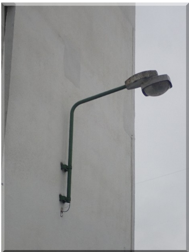
Foto PB266056: 09-i - ostatní stavby - sloupy pouličního osvětlení v areálu - výložníky (cca 10 kusů + 6 výložníků na budovách)
