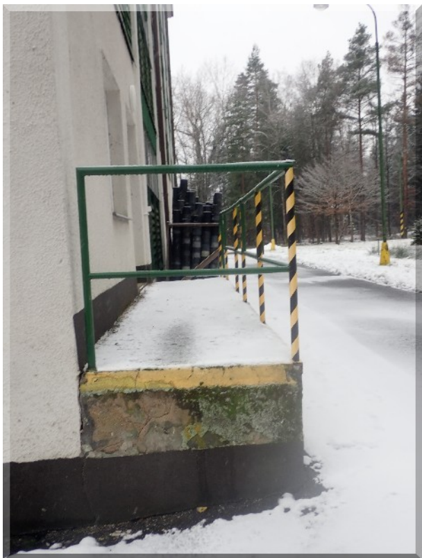
Foto PB266186: 02-y - sklad šišek - zábradlí rampy u bývalé konstrukční kanceláře (severní strana)
