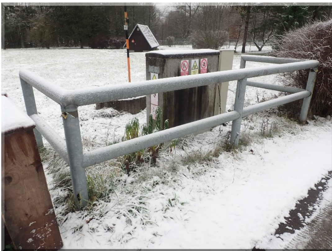
Foto PB266033: 09-c - ostatní stavby - zábradlí u regulační stanice plynu (poblíž ČOV)
