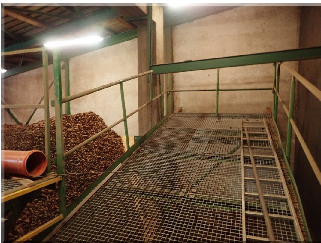
Foto PB266119: 05-i - kotelna - obslužné lávky v zásobníku vyluštěných šišek (dvě lávky vč. zábradlí)
