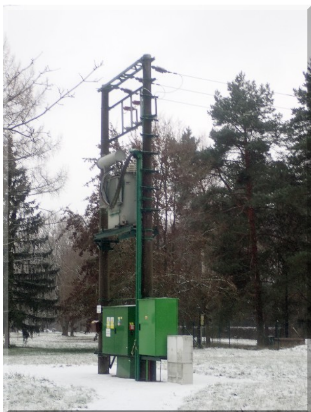
Foto PB266194: 09-g - ostatní stavby - trafostanice (sloup)
