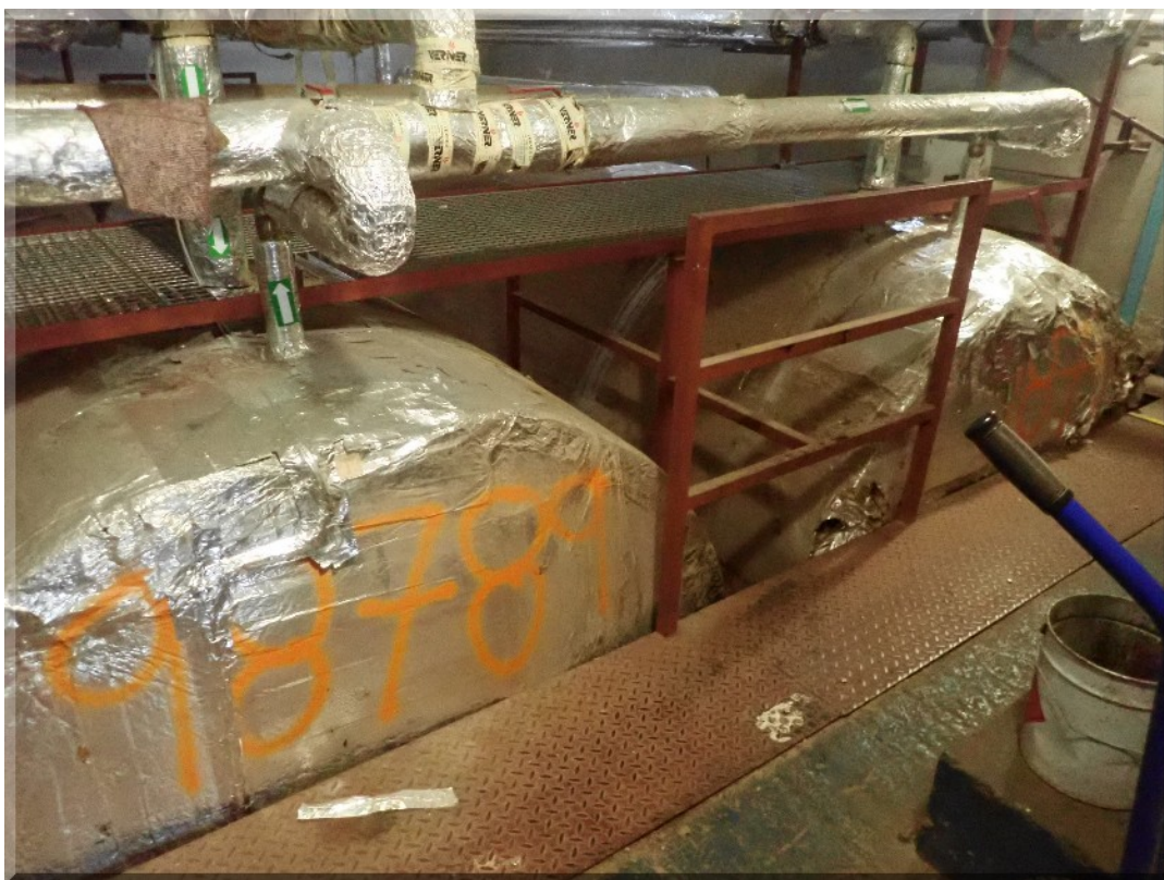
Foto PB266146: 05-g - kotelna - akumulční nádrže (plošina se zábradlím)
