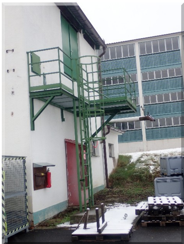
Foto PB266134: 05-j - kotelna - venkovní žebřík a obslužná lávka do zásobníku vyluštěných šišek (východní strana)
