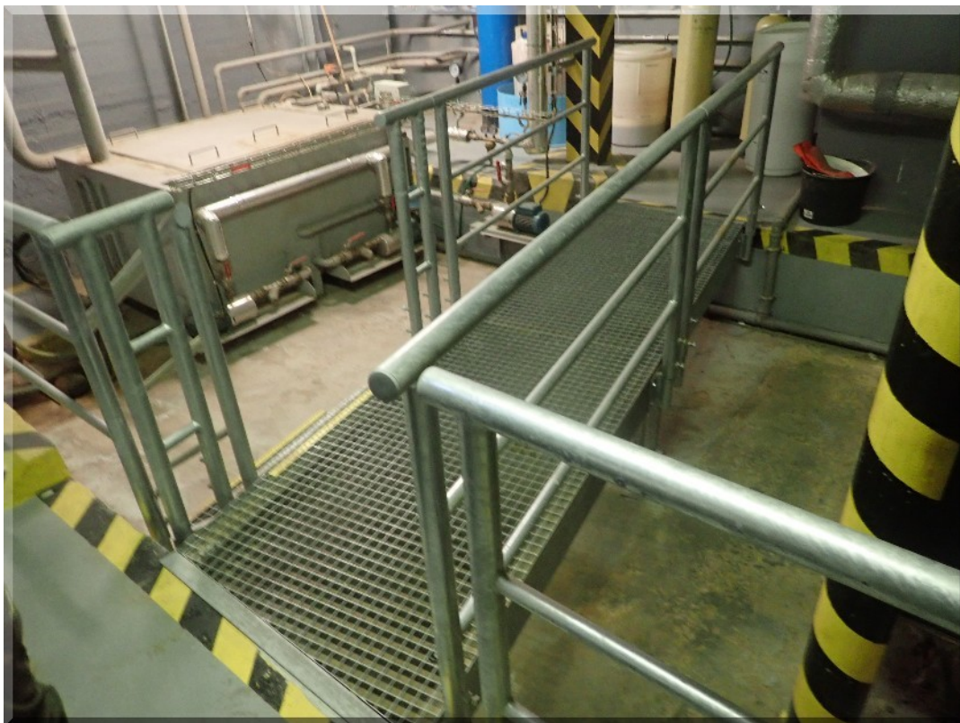
Foto PB266138: 05-c - kotelna - lávka, schody a zábradlí v suterénu (lávky, cca 3 schodiště a zábradlí, částečně odnímatelné)
