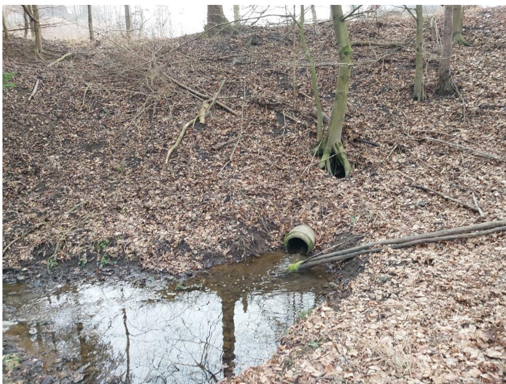
VN Batelov, vyústní objekt; u kořenu stromu kolmá díra k potrubí
