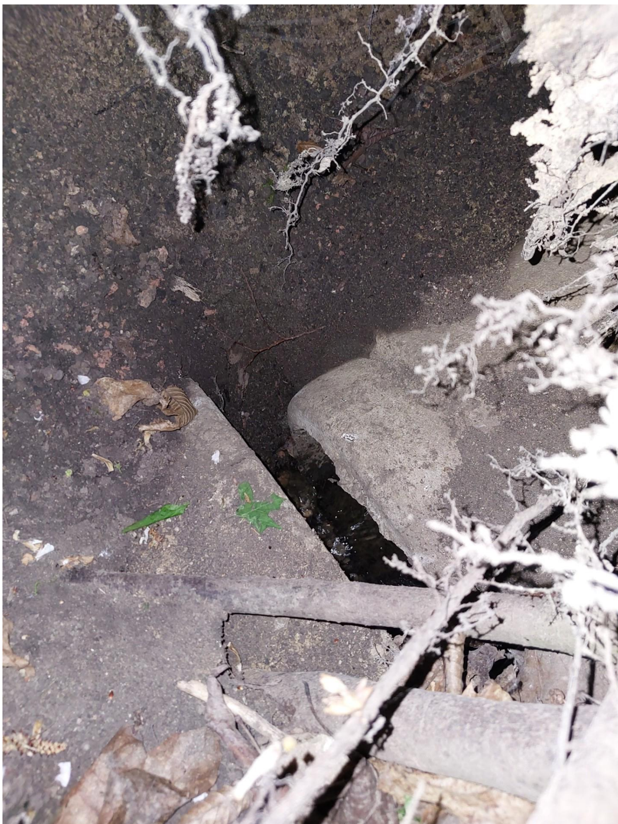
VN Batelov, rozpojené potrubí ve vzdušném líčí hráze
