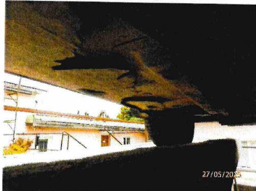
foto č.19 – pohled na poškozený kryt v levé části
