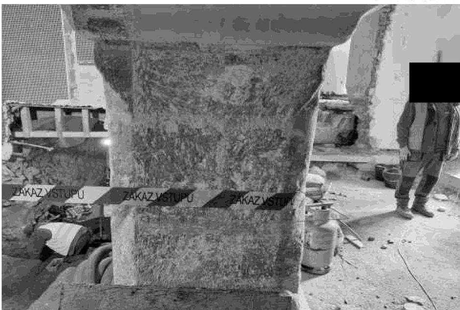
Sloup č. 1 – zkouška čištění. Znatelné spáry mezi kvádry
