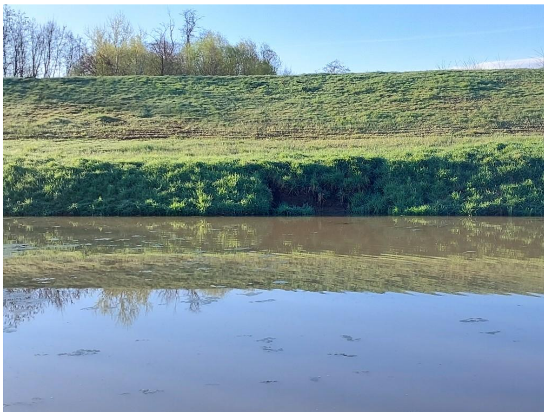
Obr. 2: Hráz SN Kameňák, viditelný sesuv hráze
