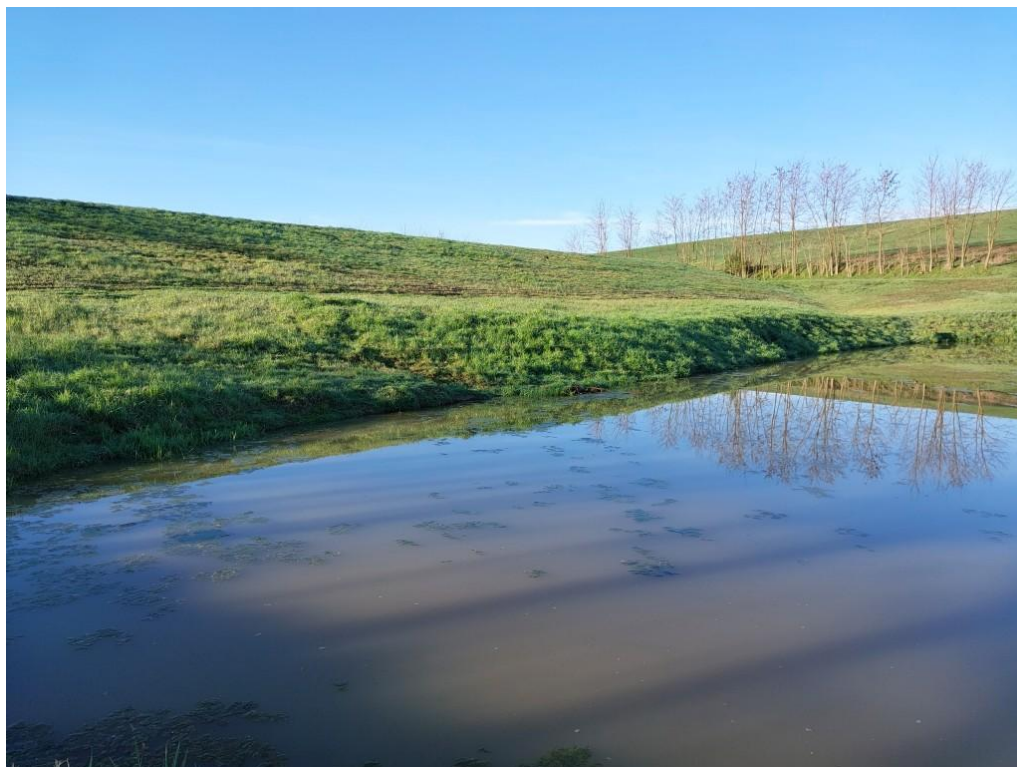
Obr. 1: Hráz SN Kameňák, vlevo viditelný sesuv hráze, vtokový objekt spodní výpusti kompletně zatopený
