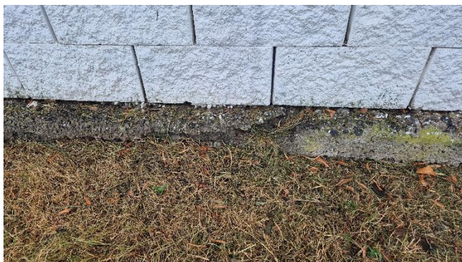
Obrázek 2 – degradovaný beton základu
