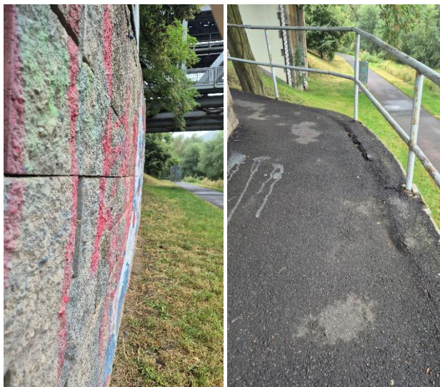
Obrázek 8 – vyklonění zdi rampy a porucha povrchu rampy
