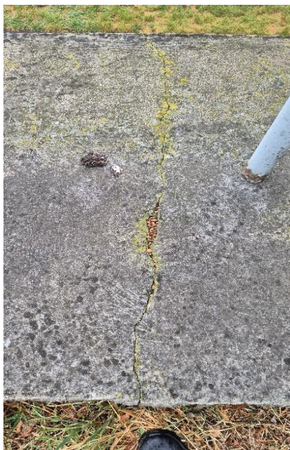
Obrázek 4 – příčné poruchy římsy
