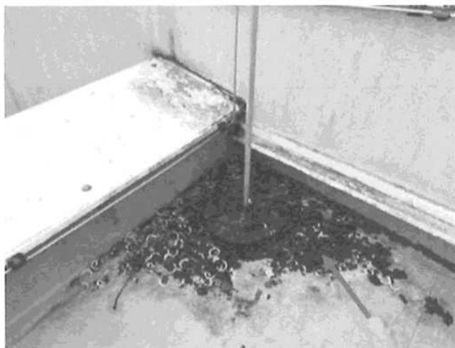
foto/82/ Zanedbaná údržba na střeše
