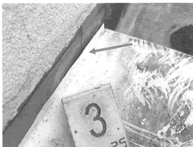
foto/28/ Netěsné napojení atiky na fasádu
