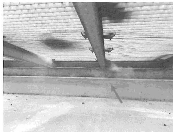
foto/43/ Únik dýmu v místě výstupu na zvýšenou část
