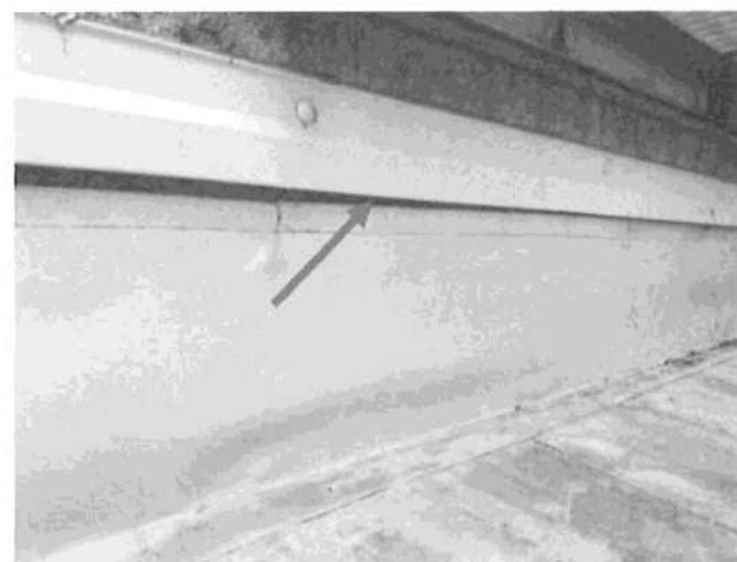
foto/74/ Absence tmelené spáry
