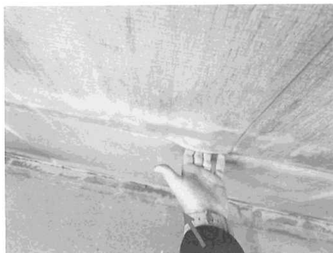
foto/67/ Porucha v místě vytažení na atiku
