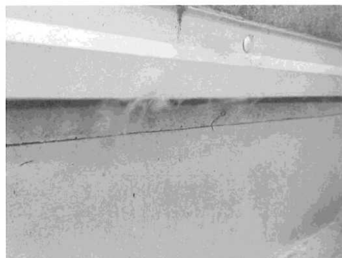
foto/42/ Únik dýmu v místě vytažení HI na fasádu
