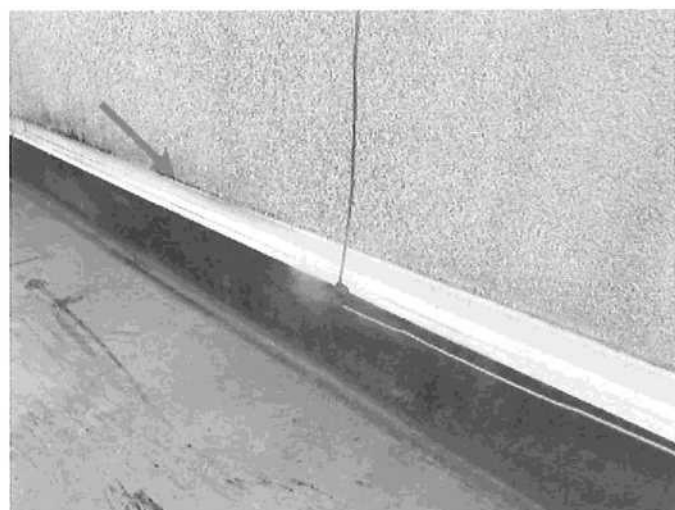
foto/24/ Únik dýmu v místě vytažení na fasádu
