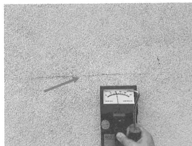
foto/62/ Trhlina ve fasádní omítce
