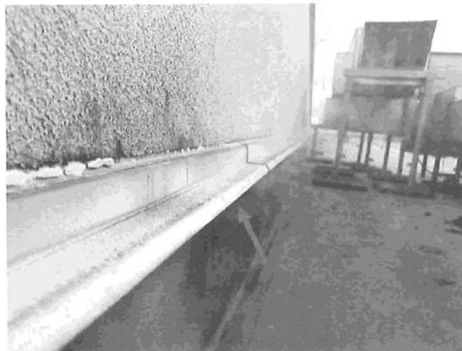
foto/07/ Únik dýmu – v místě vytažení HI na fasádu
