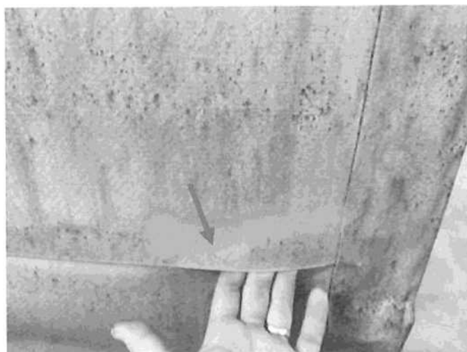
foto/66/ Porucha v místě vytažení na atiku
