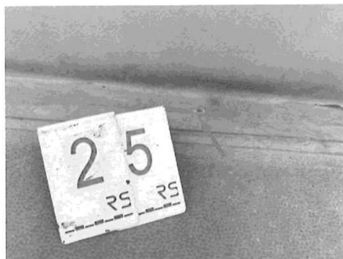
foto/54/ Defekt v ploše
