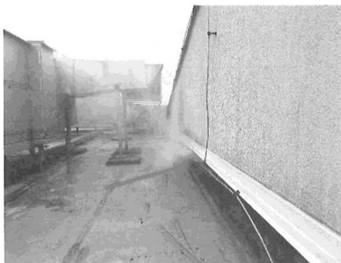
foto/23/ Únik dýmu v místě vytažení na fasádu
