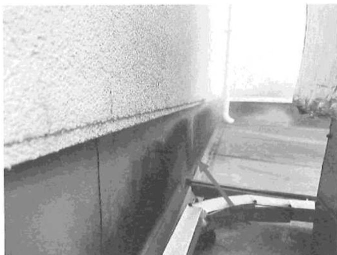
foto/06/ Únik dýmu – v místě vytažení HI na fasádu
