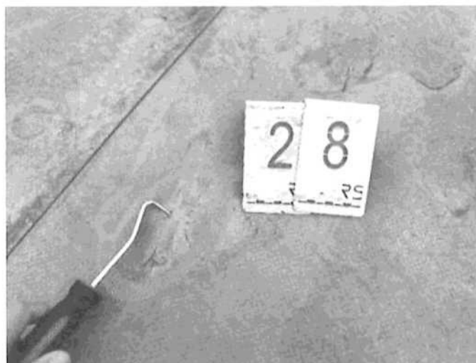
foto/17/ Defekt v ploše
