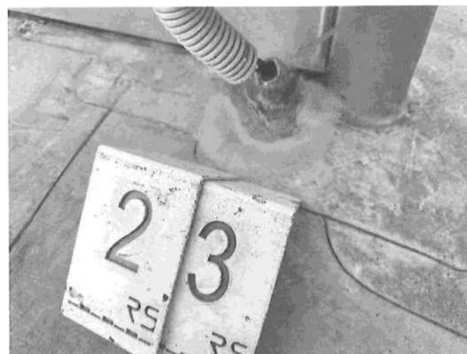
foto/36/ Netěsné opracování kabelového prostupu
