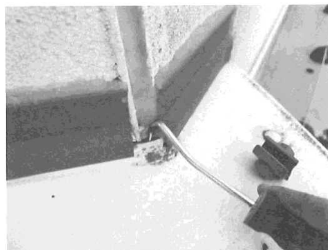
foto/78/ Nevhodné opracování klempíř. prvku
