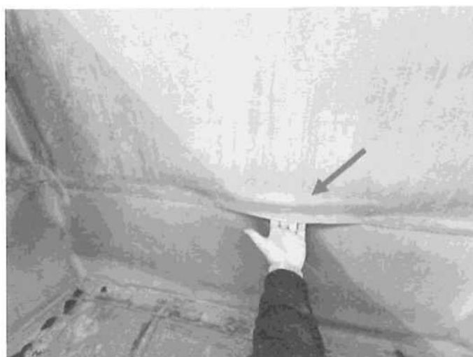
foto/68/ Porucha v místě vytažení na atiku
