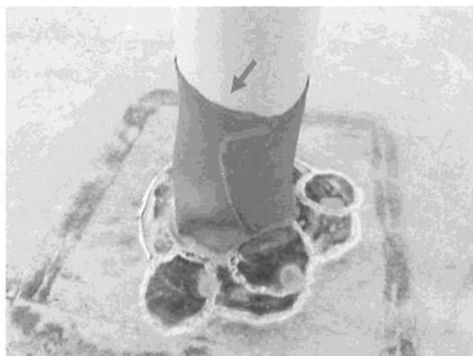
foto/71/ Nevhodné provedení opravování prostupu
