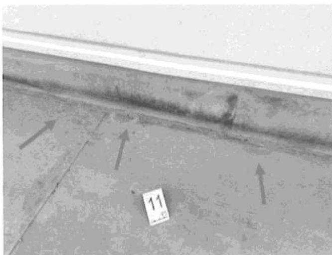
foto/47/ Tři poruchy ve sváru
