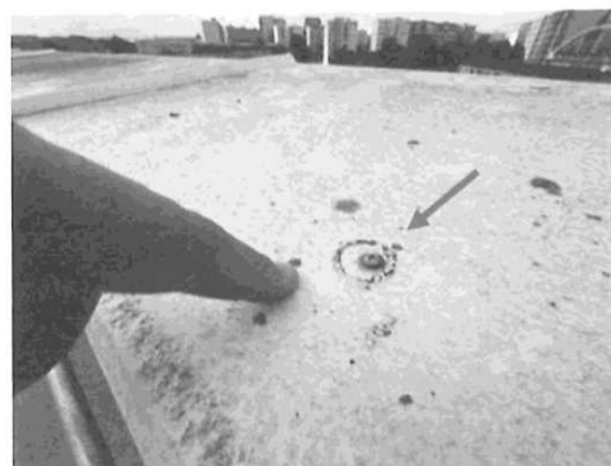
foto/79/ Absence ochranných puklíků
