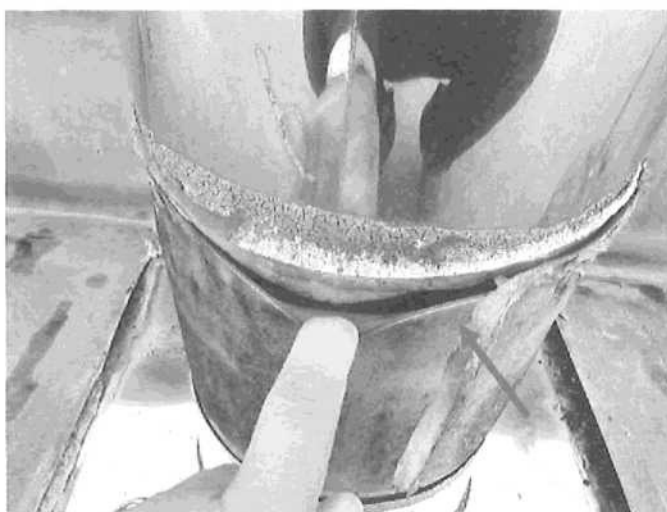
foto/70/ Degradace tmelené spáry
