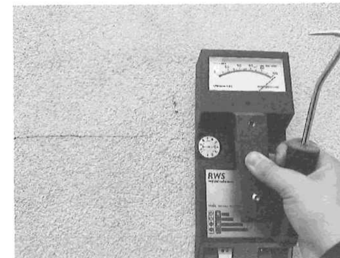
foto/63/ Trhlina ve fasádní omítce
