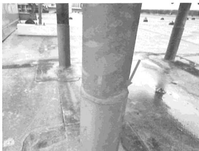
foto/69/ Degradace tmelené spáry a absence pásky
