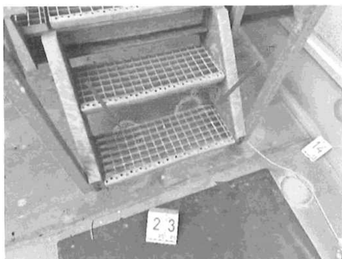
foto/52/ Defekty v ploše
