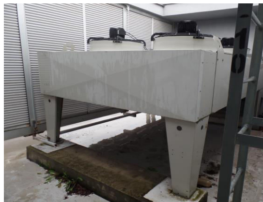
Obrázek 16: Vzduchem chlazený kondenzátor
