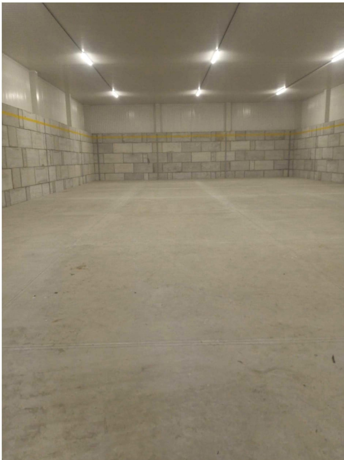
Obrázek 5. žlutá čára, spáry betonová podlaha
