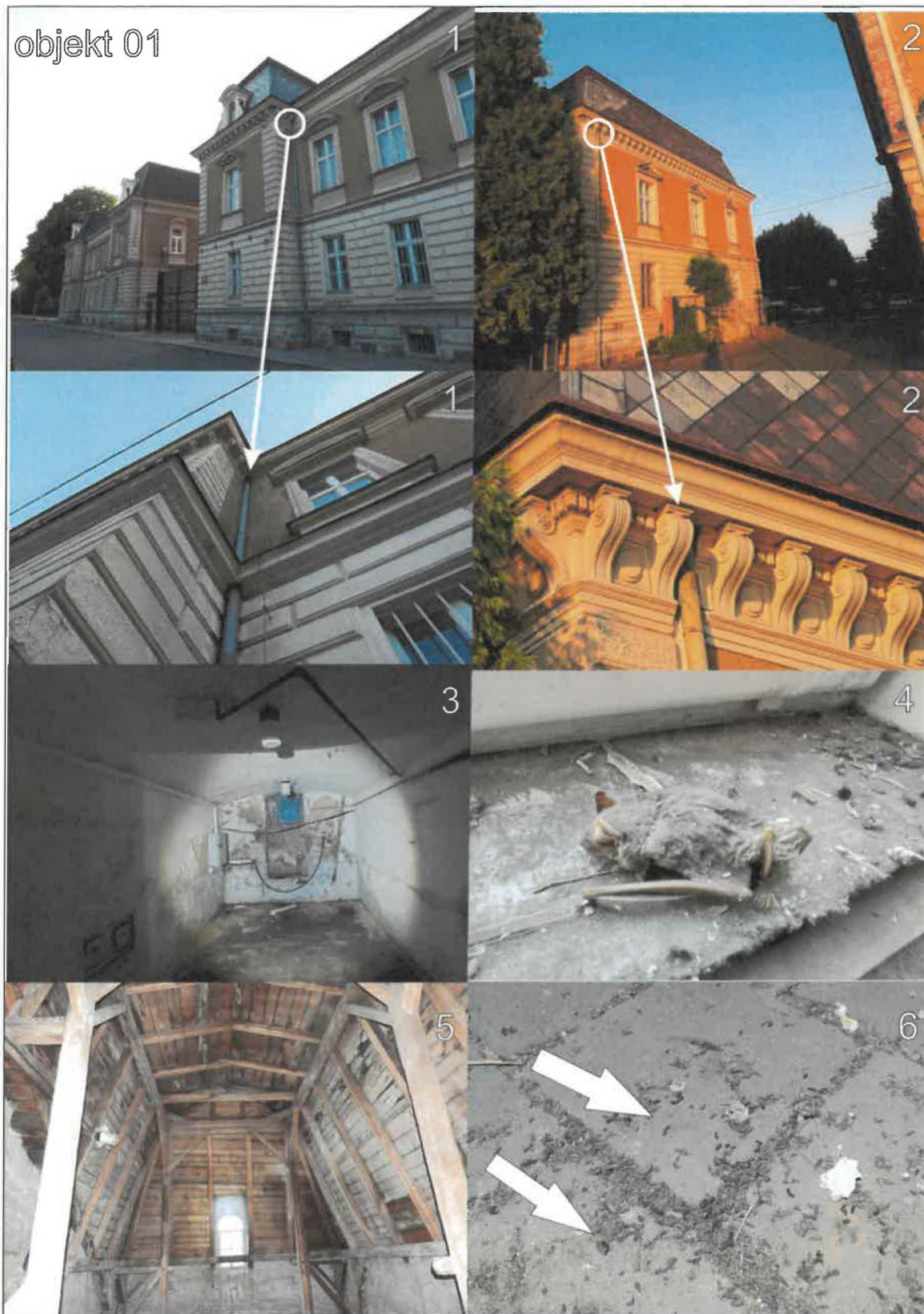
Obr. č. 1 – pohled na objekt 01 z ulice Dukelská, poz. 1 – příklady kazů kolem napojení střešy na římsy a prostory za svody okapů, které využívají netopýři tak ptáci např. rorýsi; poz. 2 – jedno z mnoha prokázaných hnízdišť rorýse; poz. 3 – ilustrační foto jedné ze sklepních místností; poz. 4 – uhynulý a mumifikovaný netopýr nalezený v meziokní 2 NP.; poz. 5 – pohled na část půdních prostor objektu 01; poz. 6 – nalezený trus netopýrů na podlaze půdy.
