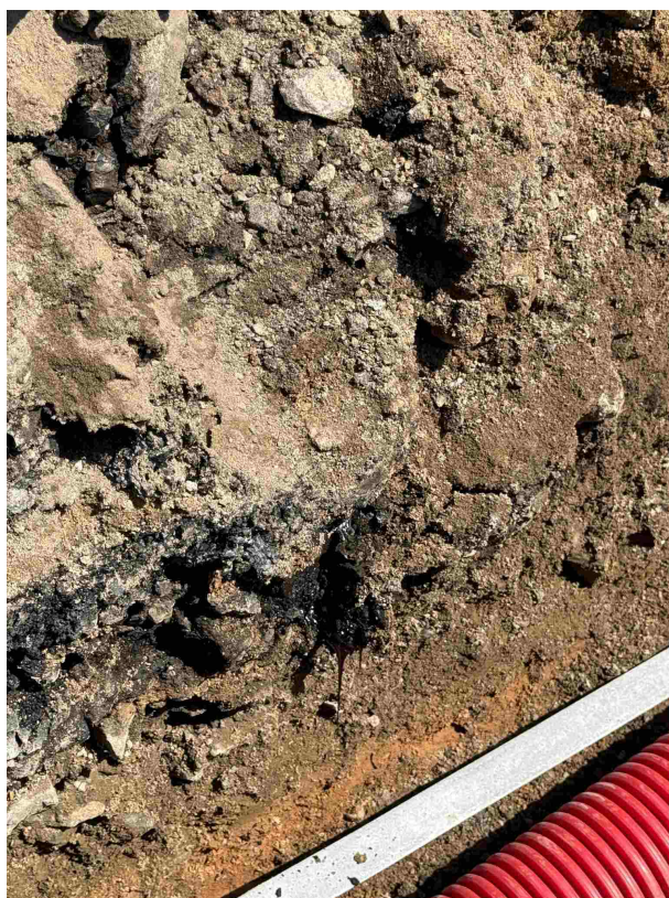
SO 105 km 3,340 – sondáž v trase inženýrských sítí, kontaminace přítomna i zde.
