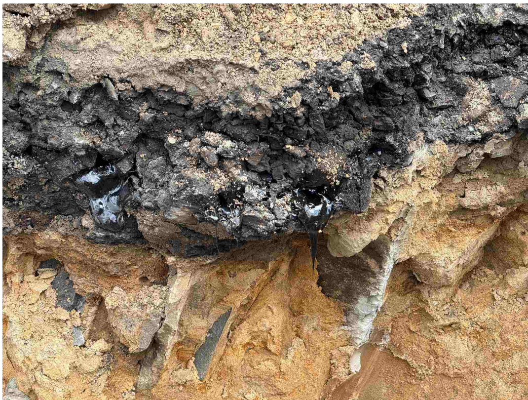
SO 105 km 3,820 – zřetelný dehtový výron ve střední části profilu.
