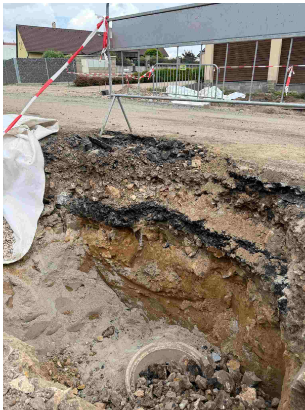
SO 105 km 3,820 – výskyt kontaminovaných vrstev v blízkosti kanalizační šachty.
