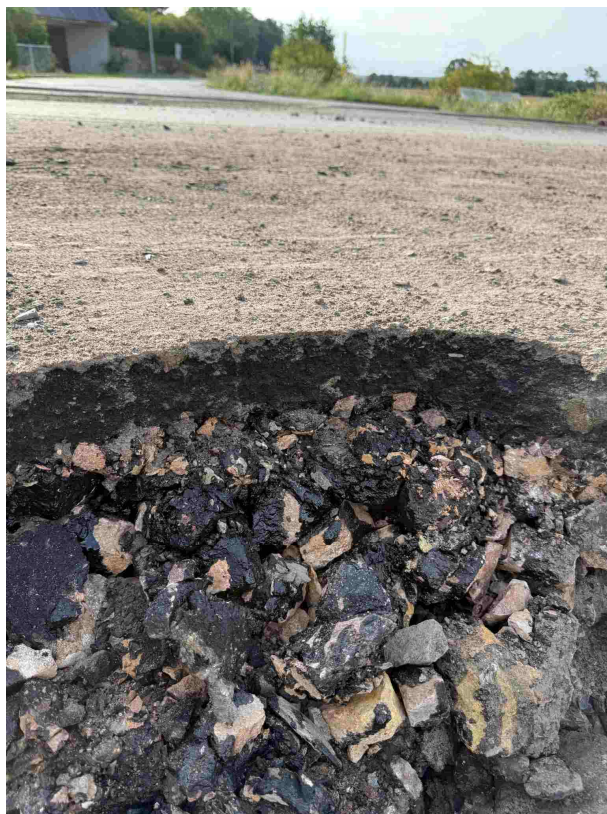
SO 105 km 3,920 – výskyt asfaltových a dehtových zbytků v konstrukčních vrstvách.
