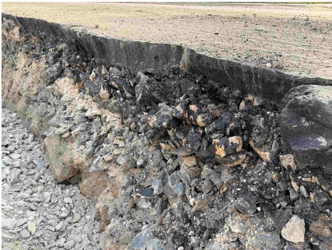
SO 106 km 4,740 – pod asfaltem navážka s vysokým podílem dehtového pojiva.
