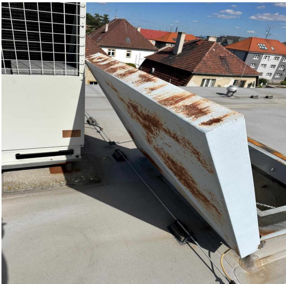
Foto /6/ detailní pohled na korodující výlez na střechu.
