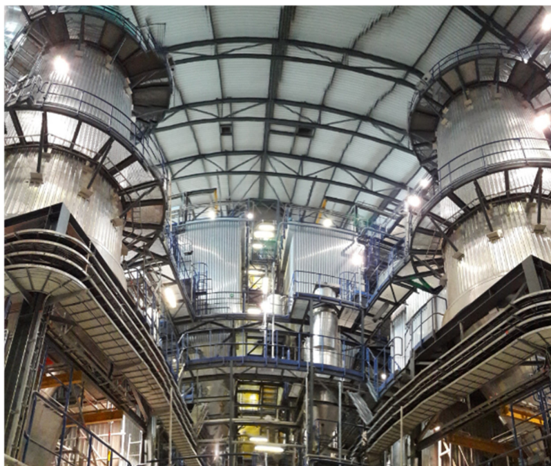
Chladicí věže LAB v WtE lince
