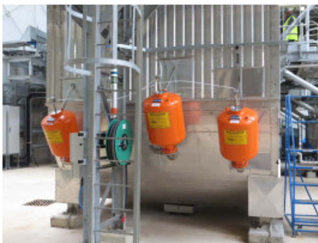
Instalované pulsní vzduchové zařízení na LAB-Loop®
