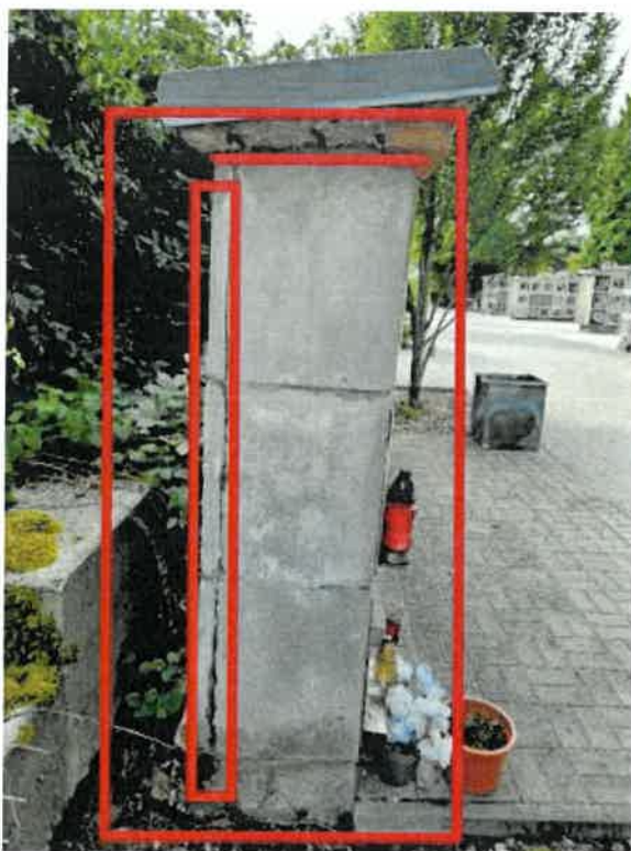
Obrázek 6 - nakloněná konstrukce, degradovaná stříška, odpadávající záda schránek
